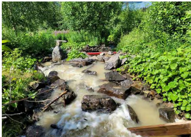
Behov for opprensning av bekkeløp
