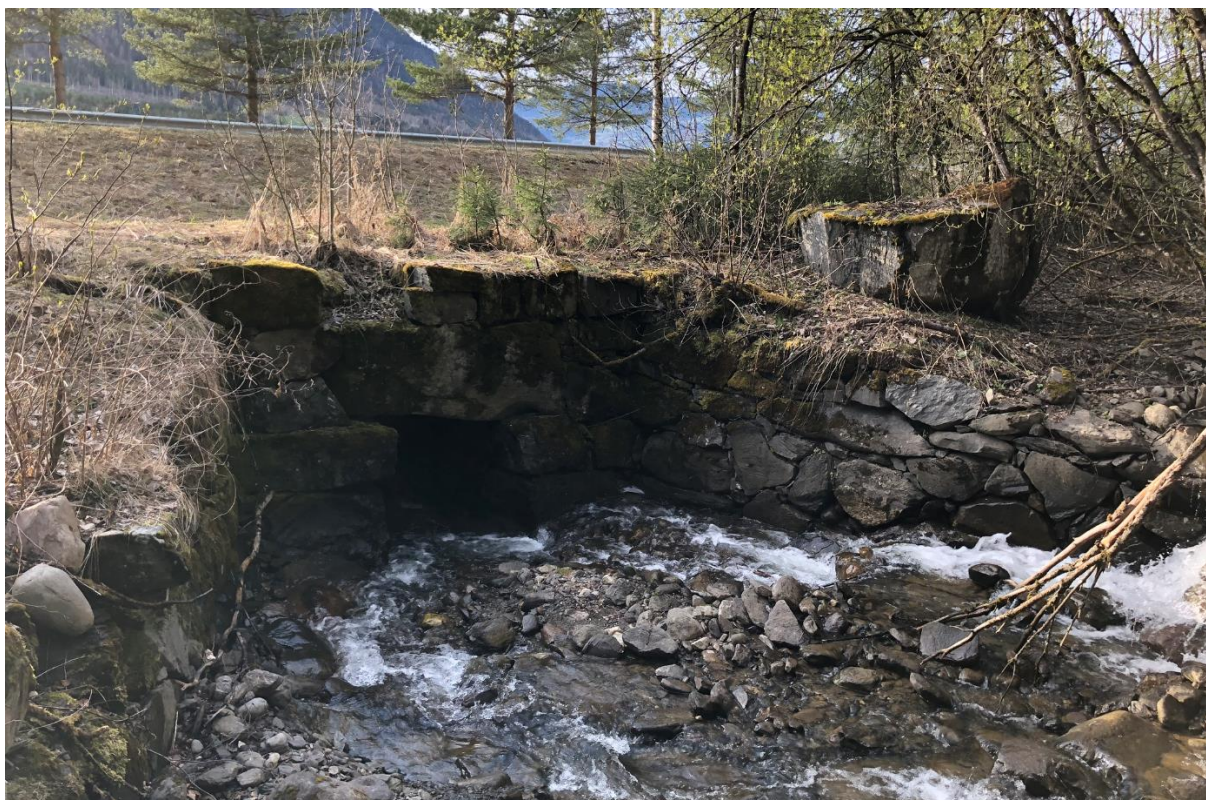
Figur 2-2-10. Stikkrenne/kulvert øst for fylkesvegen ved Merradalen/Måkrudbekken. Det er trolig arbeidet med den i flere faser, da det er ulik kvalitet og type muring på inntaket og sideplastringen. Foto: Innlandet fylkeskommune.
