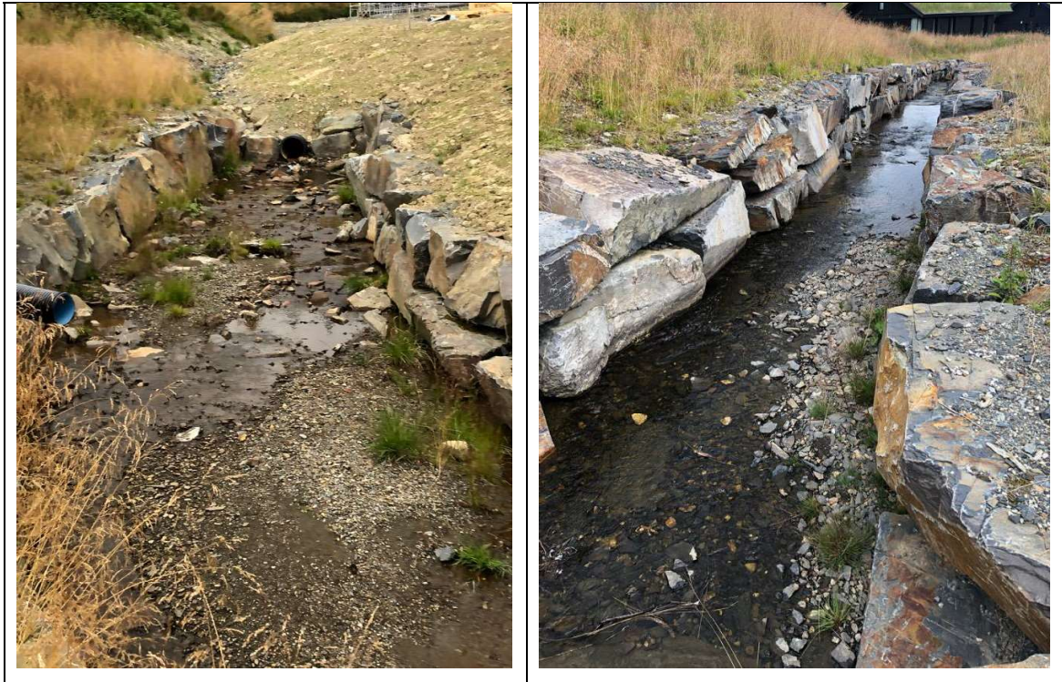
Figur 8: Bilder av eksisterende bekkeløp Nørdre Slåbekken, oppstrøms og nedstrøms adkomst vei til Skistadion (Multiconsult)
