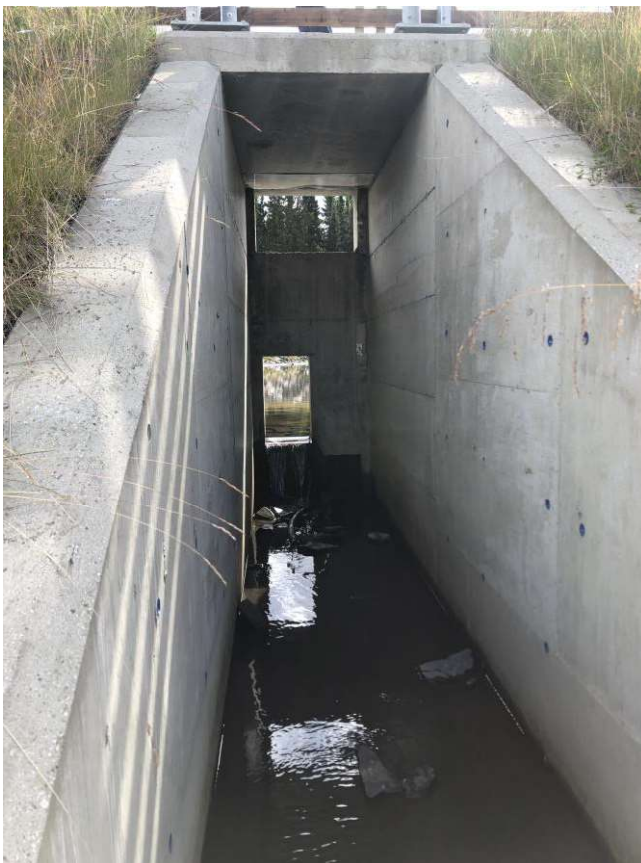
Figur 5-5 Utløpskonstruksjonen ved FLS 2, Søre Slåbekken.
