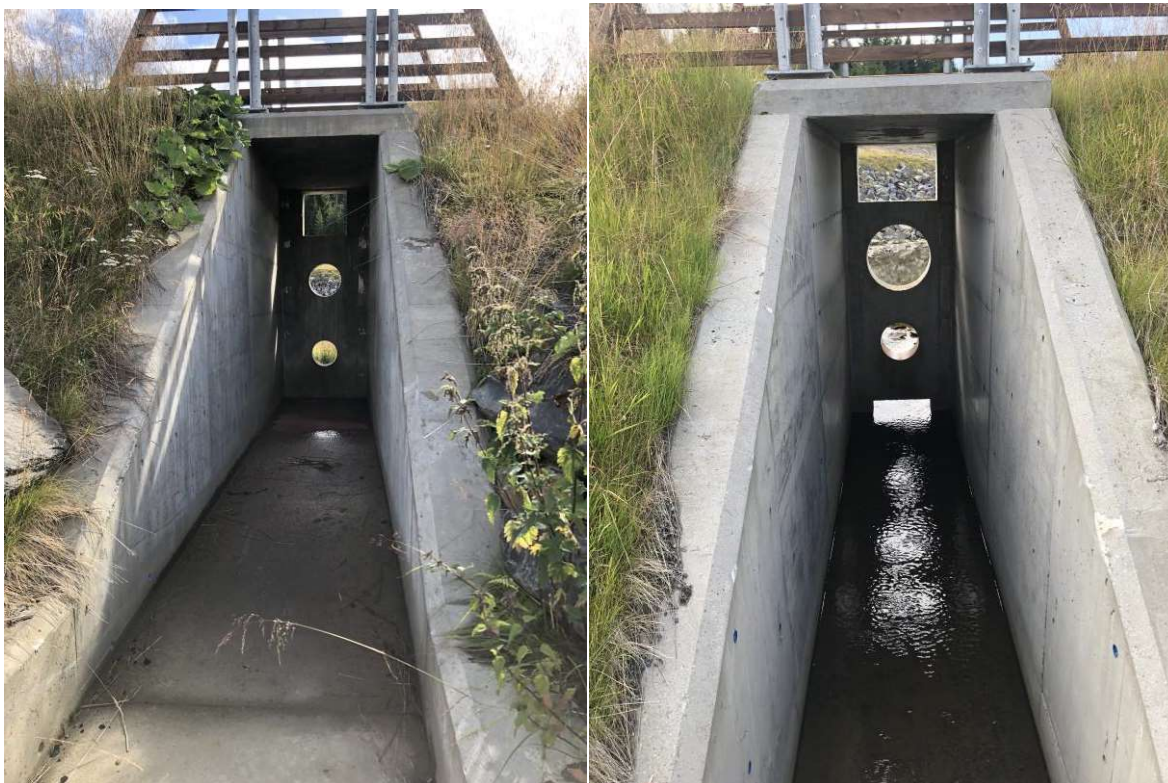
Figur 5-2 Utløpskonstruksjoner ved FLS1 mot Skurgrasbekken (venstre) og Dalanbekken (høyre). Nederste luke til høyre er stengt og derfor ikke med i de hydrauliske beregningene.
