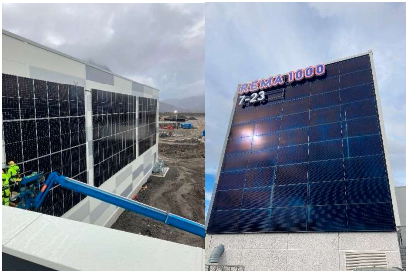
Figur 22: Eksempler på solcelleanlegg på fasader. Dersom man står nært kan refleksjon ses i panelene, men dette vil være svært nedtonet på større avstand. Dette skyldes panelens ARC.
