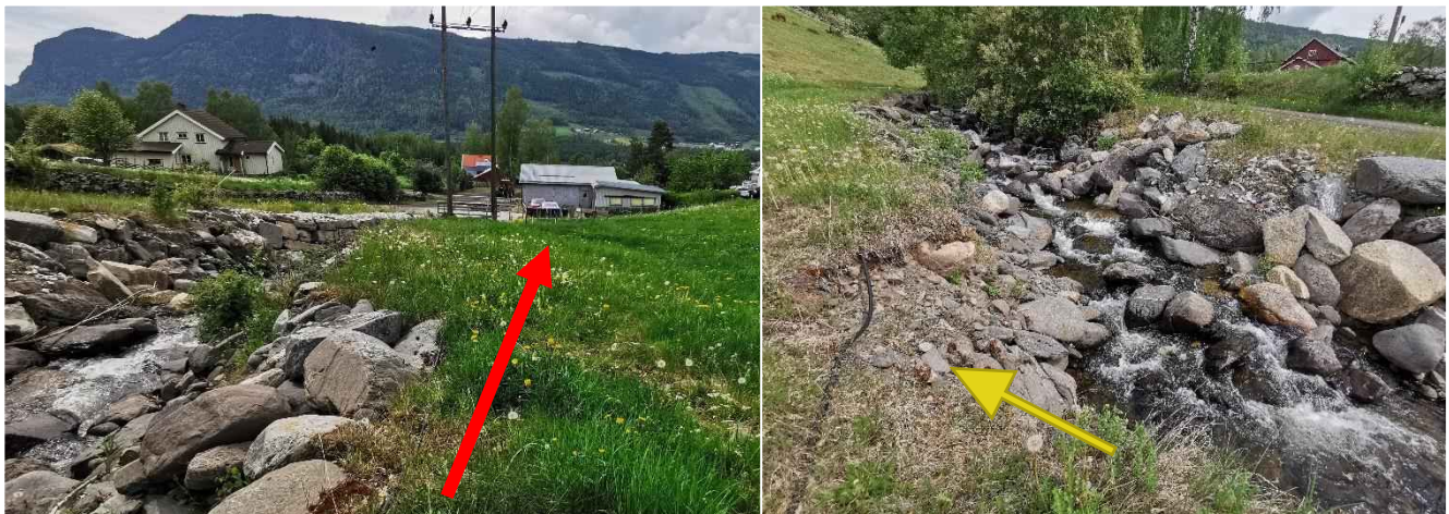
Figur 16: Oppstrøms punkt C, hvor kapasiteten i vassdraget er svært lite, og det er påbegynte erosjonsskader langs sidene. Det kan være fare for hus og veger dersom vann renner ut av bekkeløpet.
