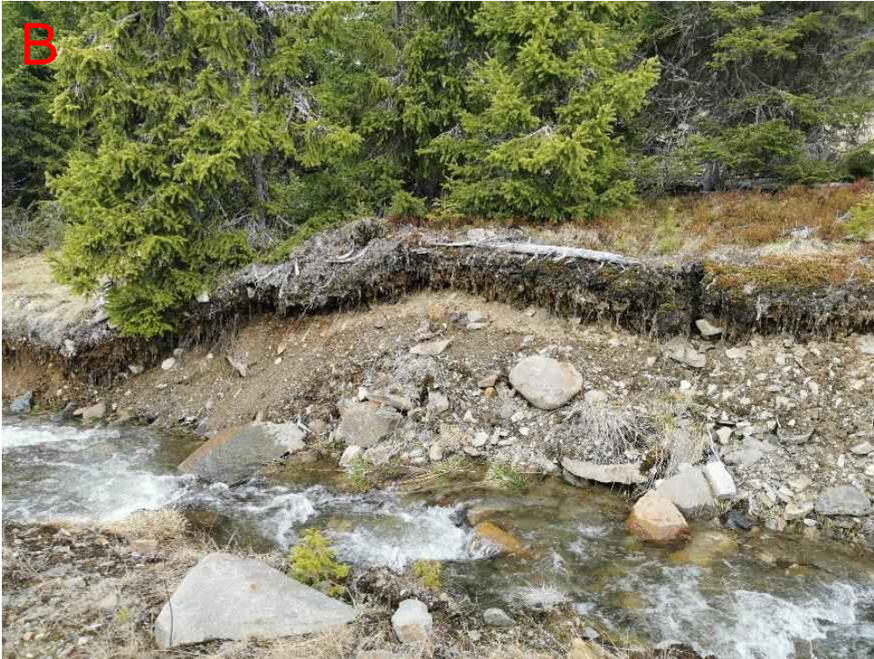
Figur 83: Erosjonsskader ved B.
