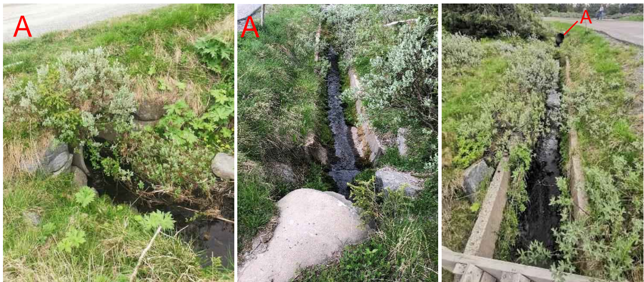
Figur 182: Bildene til venstre og i midten viser hhv. inn- og utløpet til stikkrenna (800 mm) som fører Stubberudbekken gjennom Lunnstadmyrvegen ved Lunnstadmyra. Det er en del sedimenter i innløpet. Dersom stikkrenna tettes eller går full kan vann renne ukontrollert mot bebyggelse langs Lunnstadmyrvegen. Bildet til høyre viser strekket etter utløpet, der bekken kanalisert i et halvt rør. På dette strekket kommer det et lite lukket sig fra parkeringsplassen oppstrøms.
