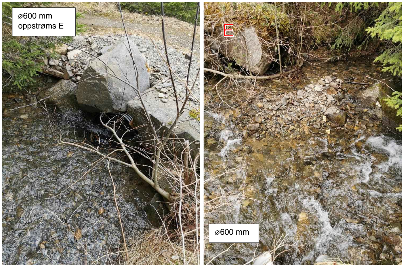
Figur 119: T.v.: ø600mm oppstrøms punkt E (ikke veldig sårbar, men har lite kapasitet). Røret er sammenklemt og nesten neddykket i sedimenter. Erosjonssikring ved innløpet er mangelfull. T.h.: Punkt E – Bildet er tatt fra stikkrenna mot oppstrøms. Stikkrenna her har også mye sedimenter ved innløpet og det er tydelig at det har vært en del problemer tidligere (blant annet er det etablert overløp/grøft på terreng tvers over alpinløypa for å lede vann på avveie tilbake til bekken). Stikkrenna er mindre enn de som er både oppstrøms og nedstrøms. Ved flom kan vann renne sørover og nedover alpinløypa mot bebyggelse lenger nedstrøms.
