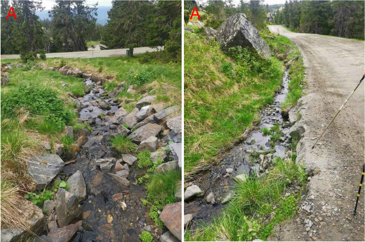
Figur 212: Bildene viser grøften ned mot punkt A. Dette er et sårbart strekke hvor bekken er kanalisert og det er erosjonsskader på vegen. Her kan vann ta på avveie mot bebyggelse dersom stikkrenna (400 mm) i punkt A gjennom Lunnstadmyrvegen går full eller tettes. På befaringsdagen var innløpet nesten tettet av blant annet erosjonsmasser fra vegen.
