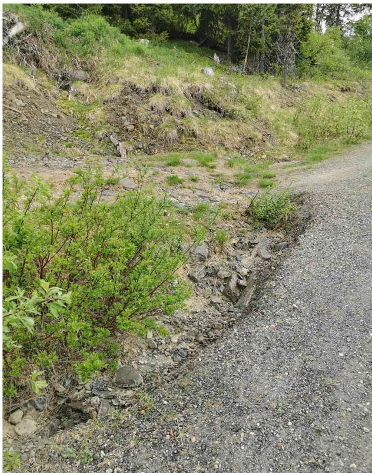
Figur 34: Erosjonsskader på vegen nedenfor hyttefeltet sør for Haugan, som følge av for lite tilrettelagt flomvei fra myrområdet oppstrøms hyttefeltet.
