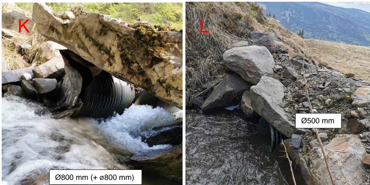
Figur 92: T.v. Utløp av stikkrenner i punkt K, som ikke nødvendigvis medfører fare for omgivelsene ved flom, men hvor det ene gjennomløpet på 800 mm er tilnærmet tett. T.h. Innløp på lukking i punkt L, som også er nært sin kapasitet ved befaringsstidspunktet. Dette er en viktig lukking og svært sårbart punkt mhp. flomfare for nedstrøms bebyggelse og vann på avveie til Kleivbekken.
