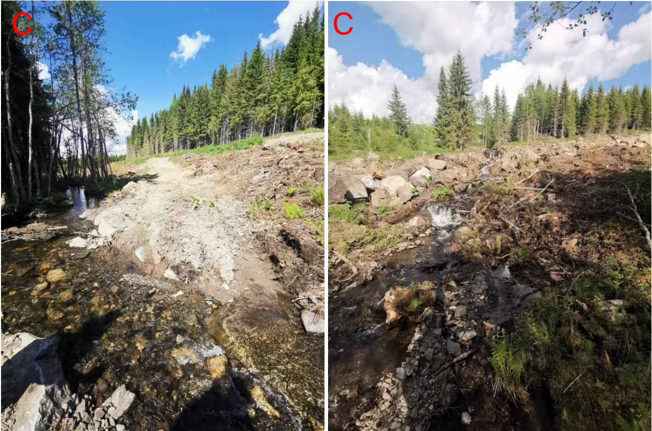
Figur 240: Bildet til venstre viser bekketraseen som er ødelagt av anleggsvei/skiløype. Dette er en av grunnene til at bekken har tatt nye veier. Her vil bekken føre med seg finnstoffer og løsmasser videre ned i bekketraseen, og muligens avsette disse på ugunstige steder. Bildet til høyre viser bekken som renner igjennom et hogstfelt like etter at den renner igjennom anleggsvegen/skiløypa.
