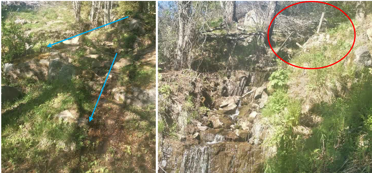
Figur 159: Bildene til viser bekkedraget mellom punkt B og C der dreneringslinjene er diffuse og det ikke er et definert bekkedrag, samt at det er lagt hogstavfall veldig nærme bekken (rød sirkel).
