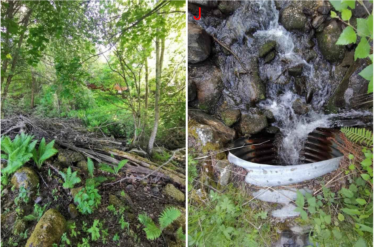
Figur 250: Bildet til venstre viser mye steiner og trær i bekken oppstrøms punkt J, som kan skape problemer i stikkrenner nedstrøms dersom det blir transportert videre med vannet i en flomsituasjon. Bildet til høyre viser innløpet til stikkrenna i punkt J.
