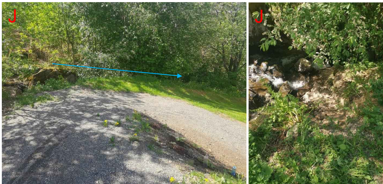
Figur 227: Ved Snippen er løsmassene fylt helt ut i bekken vannet har liten plass i en flomsituasjon. Det er også masse trær og løsmasser i bekken. Bekken går i en sving inn mot gardsvegen, hvor det er fare for at vann tar på avveie mot bebyggelsen på tomten.
