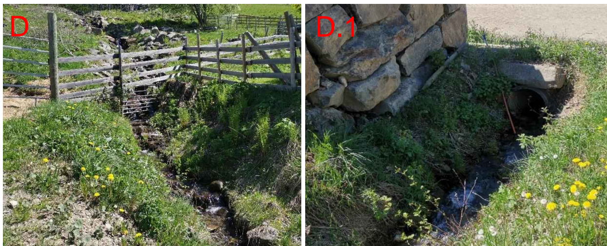
Figur 135: Bildet til venstre viser bekkefaret rett oppstrøms Larshågån med mange store steiner i bekkeløpet. Bildet til høyre viser innløpet til stikkrenna (600 mm) som fører Gunnerheimbekken under Fjellstadvegen. Dersom denne stikkrenna går tett/full, kan vann ta på avveie mot bebyggelse i området.
