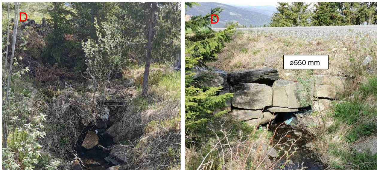
Figur 75: Oppstrøms stikkrenna i punkt D er bekkeløpet fylt igjen med hageavfall, isopor og paller (venstre bilde). Det er nærmest ikke kapasitet igjen. Ved flom kan deler av dette bli med vannet og tette igjen stikkrenna i punkt D (høyre bilde), som har liten kapasitet i utgangspunktet. Dette vil medføre flomskader nedstrøms langs flomveien.
