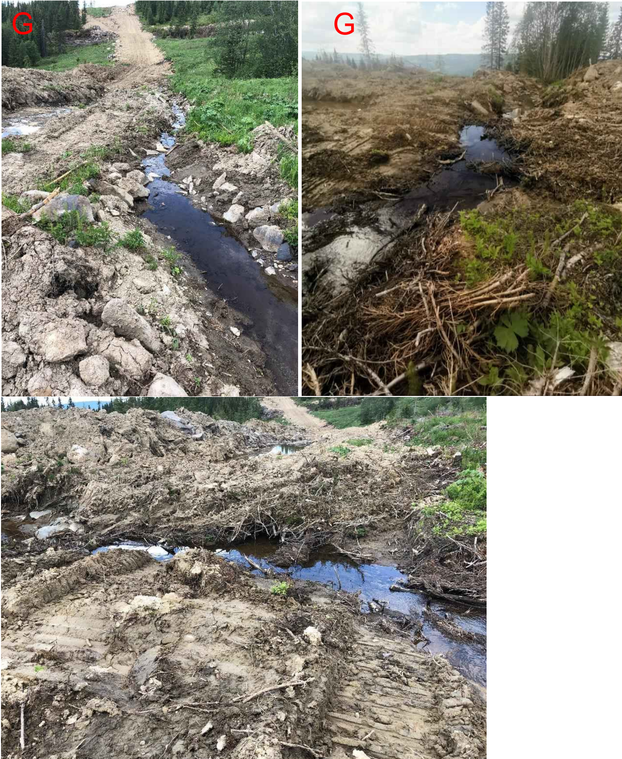
Figur 222: Bildene viser rasering av Bjørgebekken som følge av anleggsarbeider og hogstmaskiner hvor bekken ikke er hensyntatt. Løsmassene har blitt og blir stadig vasket ut og ført med bekken.
