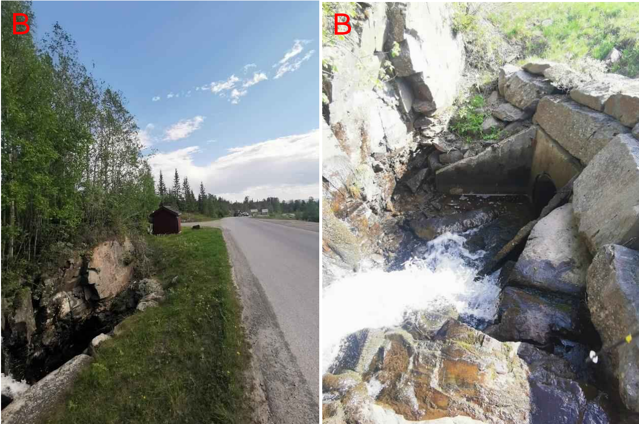
Figur 238: Potensielt flomoverløp langs Hundersætervegen vises i bildet til venstre og innløpet til stikkrenna (1000 mm) gjennom Hundersætervegen i bildet til høyre.
