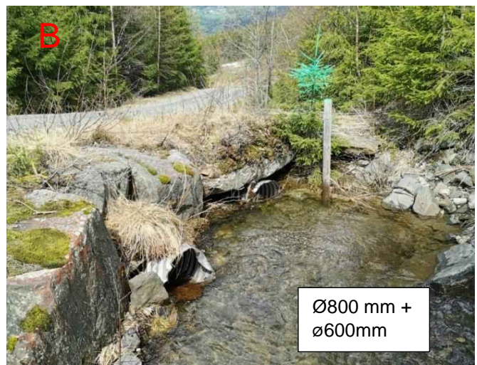
Figur 117: Punkt B - Innløp med mye sediment som begrenser kapasitet. Flomveien vil være nordover langs vegen.
