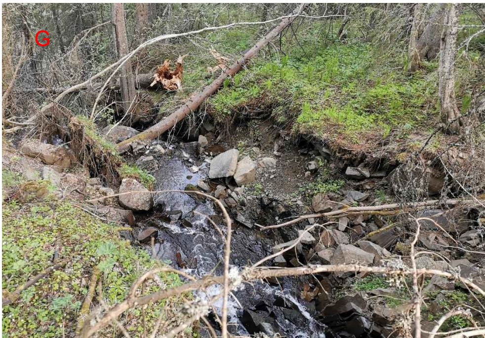
Figur 78: Nedstrøms siste stikkrenne før utløp i Mosåa har bekkeløpet mye erosjonsskader og vindfall/undergravde trær, som fører til stor massetransport ut i Mosåa.
