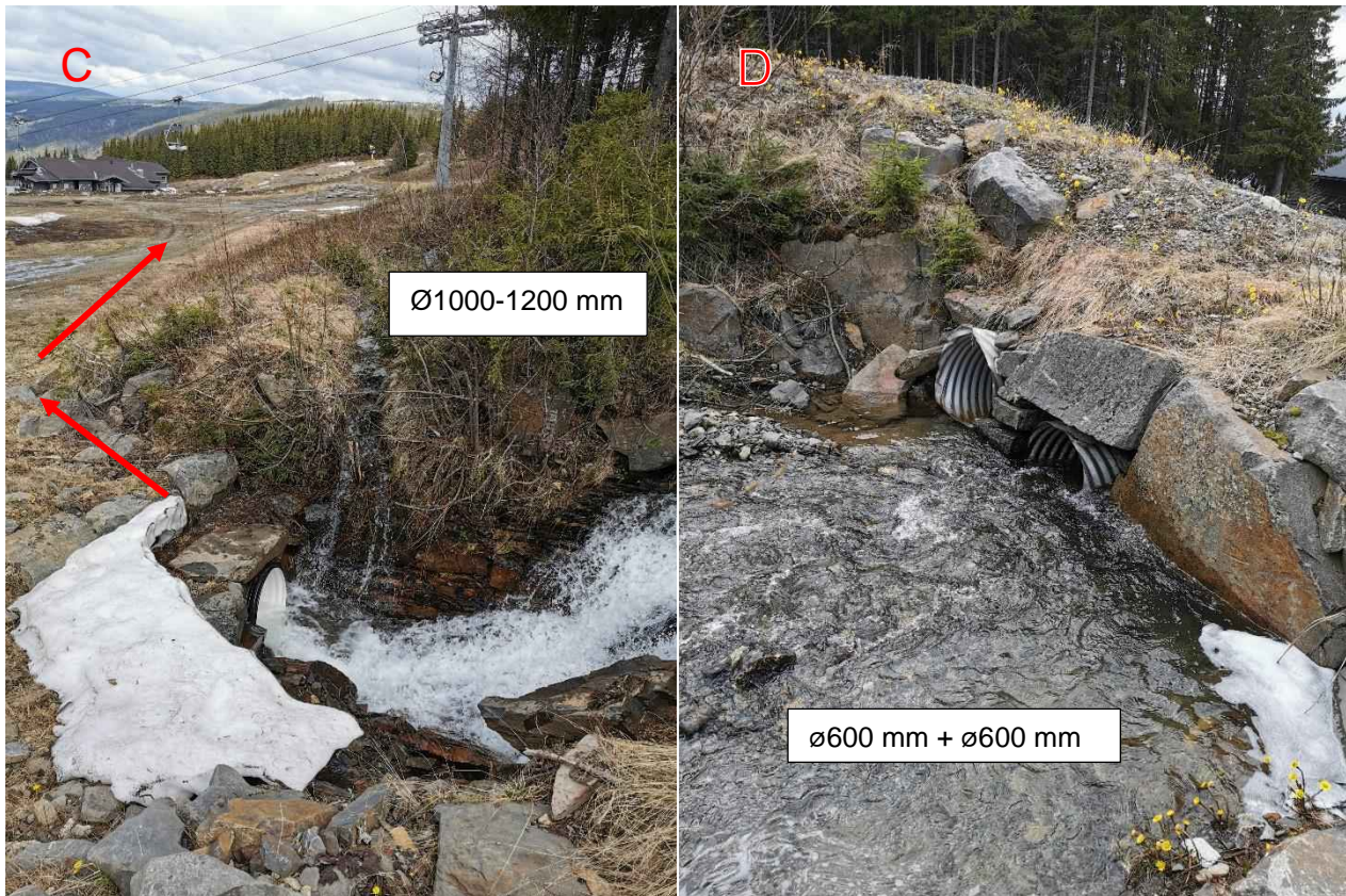
Figur 118: T.v. Punkt C – Innløp av stikkrenne har begrenset kapasitet, og ved overtopping renner vann raskt ut på terreng og nordover.: T.h.: Punkt D: Innløp utsatt for gjentetting. Delvis neddykket og mye sedimenter ved befaringstidspunktet. Flomvei fra begge punkter er angitt i Figur 115.
