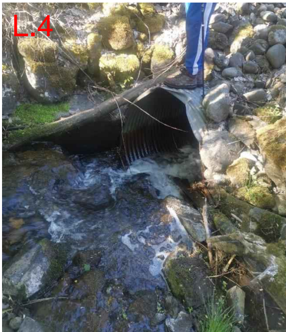
Figur 207: Innløpet til stikkrenne L.4 (1000 mm). Det er et sårbart innløp, med bl.a. sedimenter foran innløpet.
