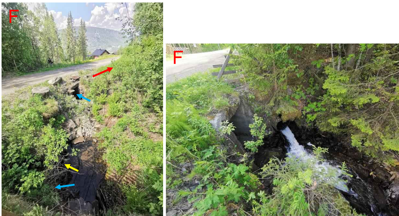
Figur 244: I bildet til venstre vises hvordan bekken tas igjennom Gamle Hundersætervegen. Gul pil viser hvor vannet går i en normalsituasjon gjennom en 600 mm stikkrenne. Blå piler viser hvor vannet går i flomoverløp i 1000 mm stikkrenne og 800x1500 mm kulvert. Rød pil viser hvor bekken kan ta på avveie dersom stikkrennene tettes eller går full. I bildet til høyre vises utløpet til stikkrenna.
