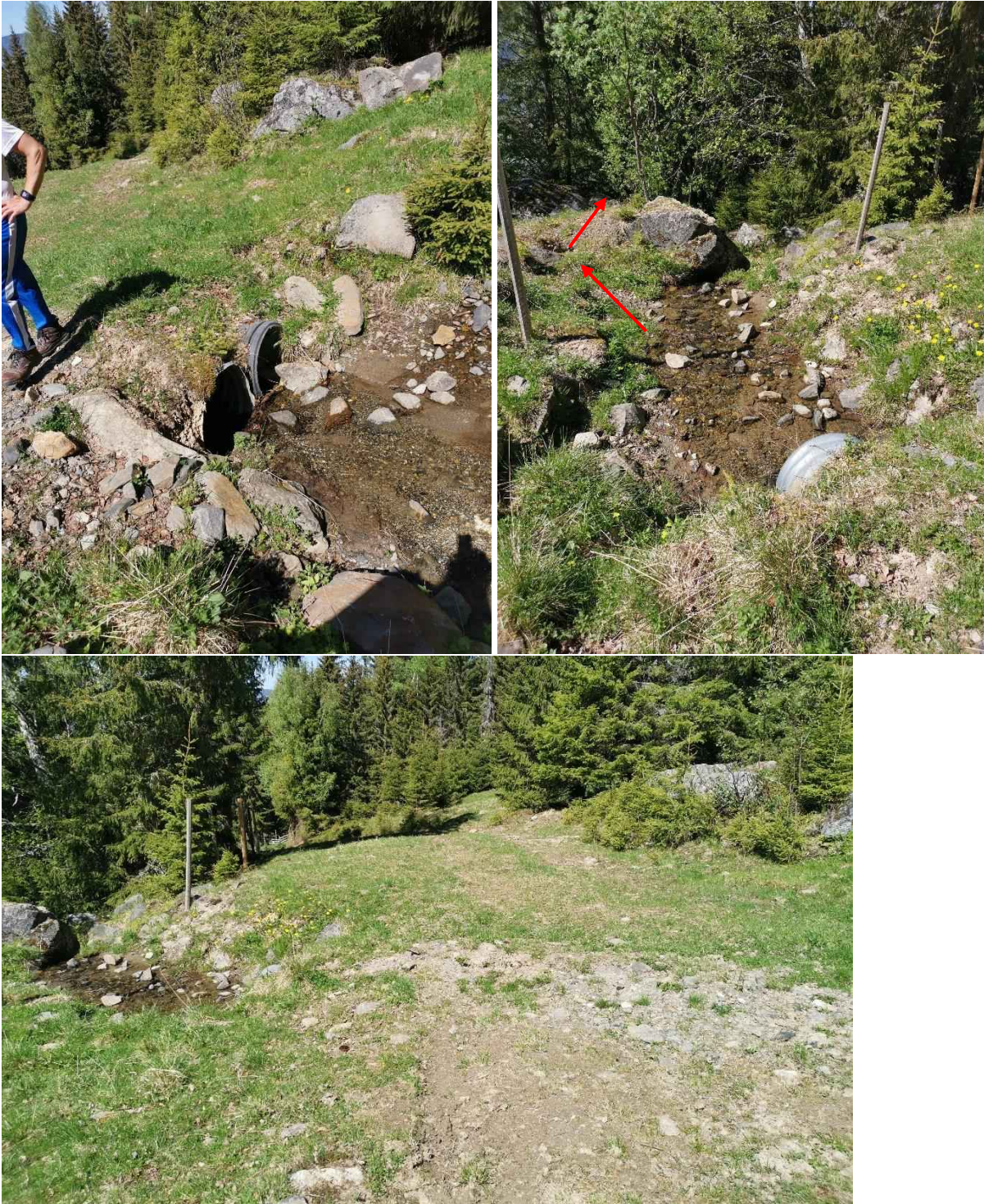
Figur 132: Bildet øverst til venstre viser innløpet på stikkrenner (600 mm og 500 mm) under skiløypa like nedstrøms punkt B, hvor man ser erosjon på oversiden av og rundt stikkrennene. Bildet øverst til høyre viser utløpet til stikkrennene. Her ser man at det har erodert på oversiden av og rundt utløpet til stikkrenna, samt at vann har vært på avveie nedstrøms utløpet (vist med røde piler), men at vannet antakelig har drenert inn i bekkeløpet igjen. Det nederste bildet viser erosjon i skiløypa over stikkrennene.
