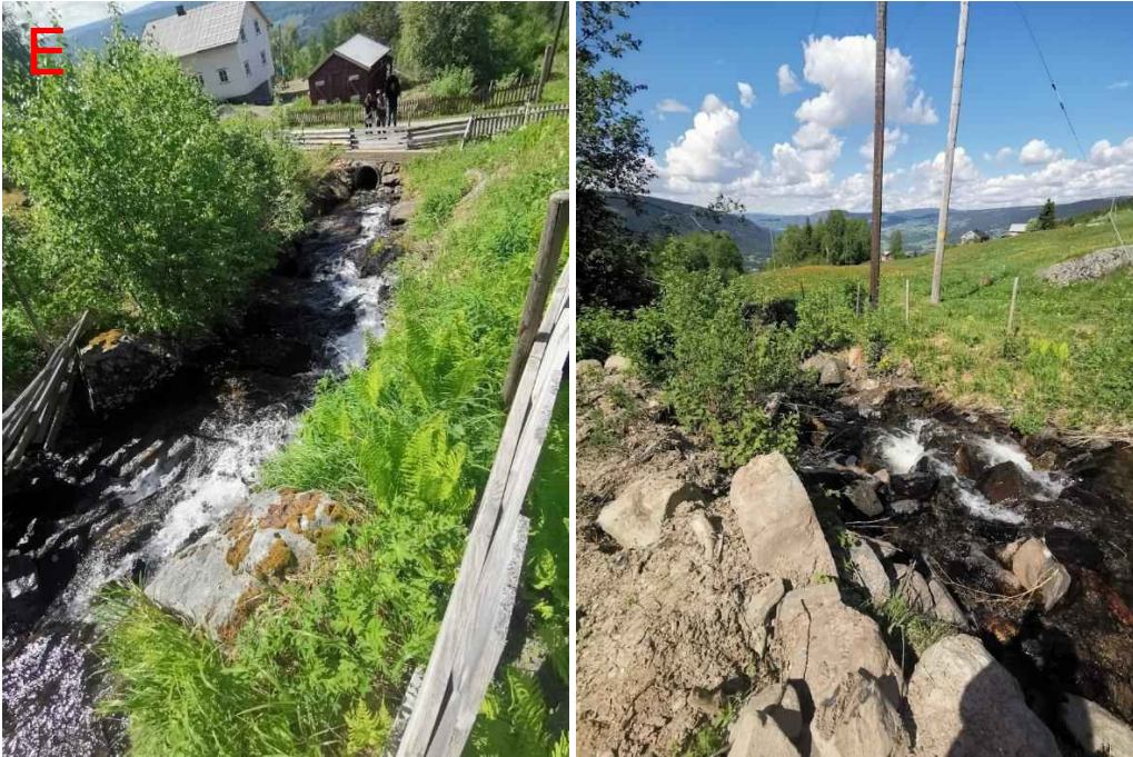
Figur 243: Bildet til venstre viser stikkrenna gjennom Gamle Hundersætervegen ved Bekkelund. Bildet til høyre viser at det er fylt ut mot bekkeløpet (på sørsiden av bekken), og at bekkeløpet dermed har blitt smalere. Dette gir også fare for at fyllingen tas med bekken i en flomsituasjon og tetter stikkrenner lenger nedstrøms.
