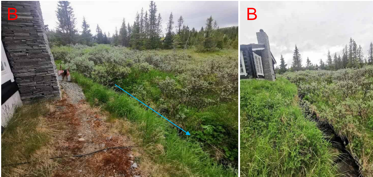
Figur 213: Hytten i Vardvegen 25 ligger veldig nærme bekken, og bekkeløpet er trangt og kanalisert. Dette er et sårbart punkt hvor bekken kan gjøre skade på hytten.
