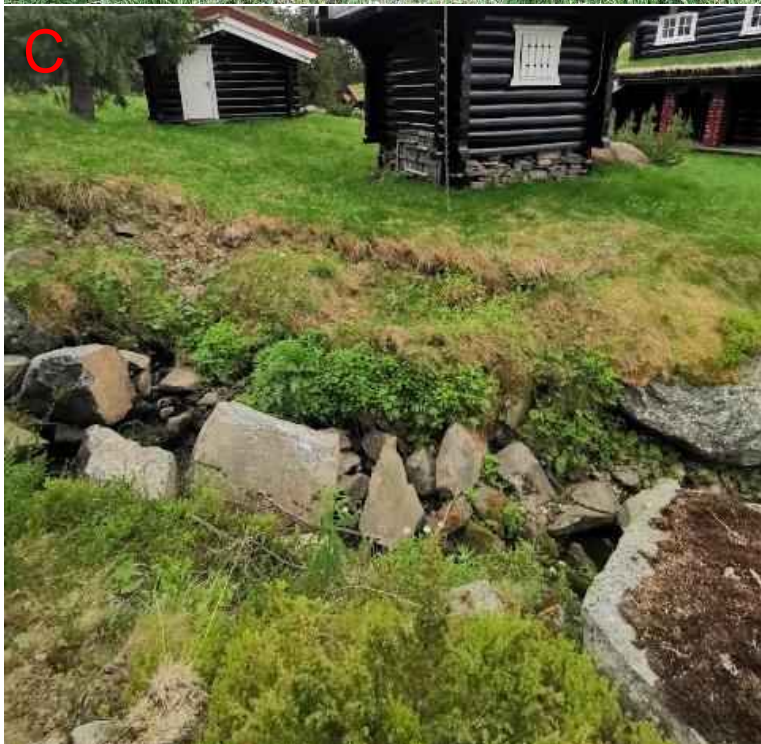
Figur 184: Bildene viser punkt C, hvor en stikkrenne (1000 mm) fører Stubberudbekken igjennom Vardvegen. Stikkrenna er litt gjengrodd og har sedimenter ved innløpet, men dette hindrer ikke kapasiteten nevneverdig. Bildene øverst illustrerer godt hvordan bekken ser ut hhv. når den kommer sigende ut av et myrområde i naturlig bekkeløp, og fremstår som liten, kontra når den er kanalisert og steinsatt, og fremstår som mye større med en gang. Nederst er bilde rett nedstrøms punkt C, som viser en fylling som holder på å rase ut i bekken, med fare for å tette stikkrennene nedstrøms. Videre nedstrøms er det mye hogstavfall og søppel i bekkeløpet. Dersom stikkrenna går full eller tettes vil vann antakelig renne langs Vardvegen og over i Bjørgebekken, men på vei til Bjørgebekken kan vannet også ta over Vardvegen og mot bebyggelse.
