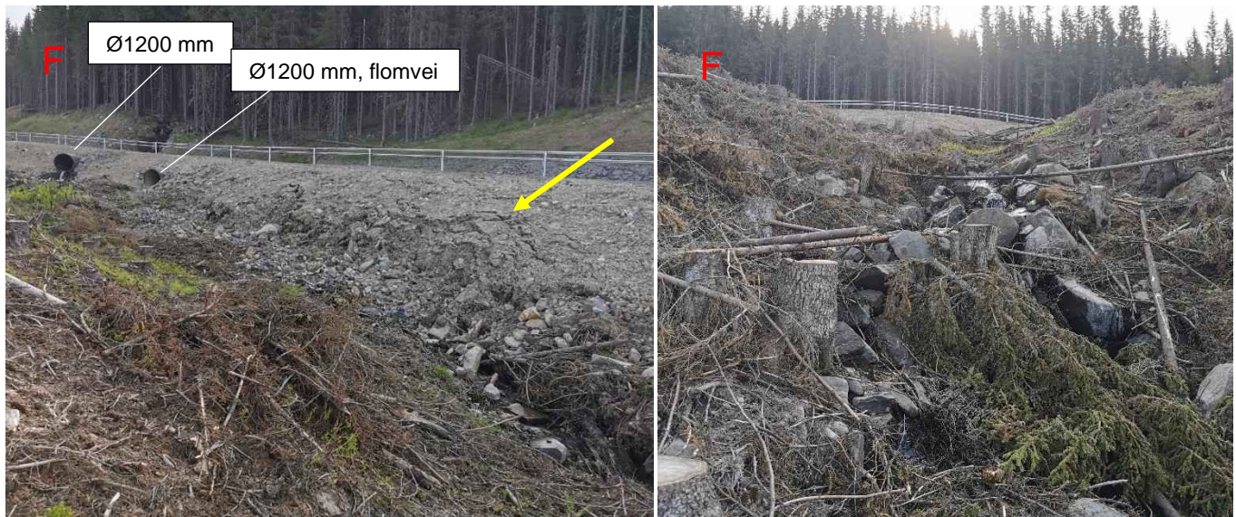
Figur 77: Skurgrasbekken nedstrøms kryssing av Mosætervegen (F). Vegen er fylt ut/utvidet delvis over bekkens løp som har medført mye erosjon av vegfyllinga som består av mye finmasser. Det er ikke ryddet opp tilstrekkelig etter hogstarbeider i et stort område nedstrøms Mosætervegen og mye trær og kvist ligger i bekkeløpet.
