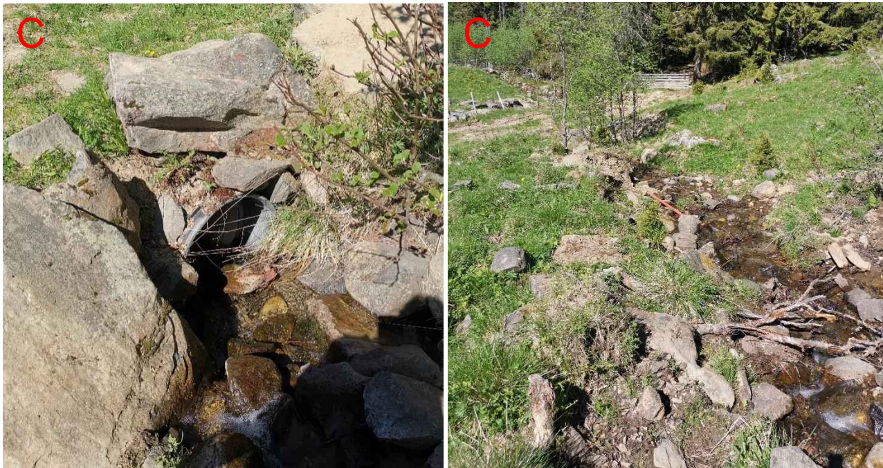
Figur 134: Bildet til venstre viser innløpet til stikkrenna i punkt C (600 mm). Bildet til høyre viser bekketraseen før innløpet til stikkrenna. Det er mye kvister, stein og løsmasser i bekkeløpet som har potensiale for å bli dratt med ned til innløpet av stikkrenna i en flomsituasjon. Dette er en sårbar stikkrenne fordi vann kan ta på avveie mot Larshågån dersom stikkrenna går full eller tettes.
