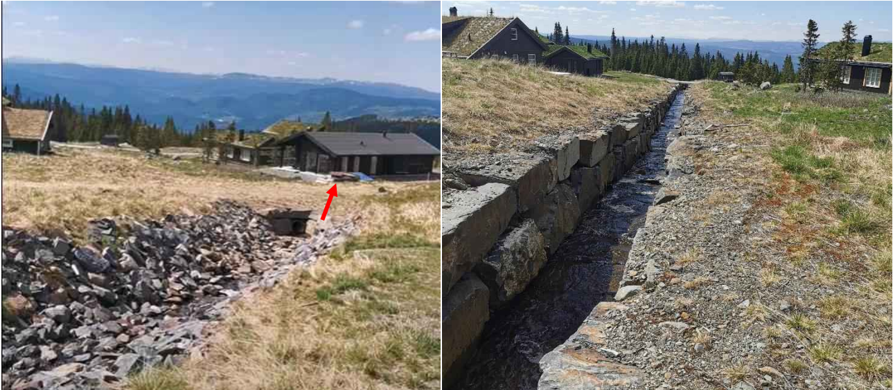
Figur 46: Til venstre: Innløp av stikkrenna i punkt A, hvor kapasitetsproblemer kan medføre fare for bygninger nedstrøms. Bilde til høyre viser der Søre Slåbekken er lagt i en forholdsvis dyp, smal og rett kanal.
