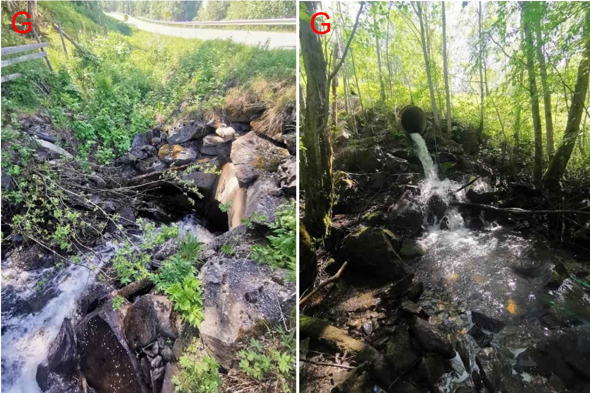
Figur 245: I Punkt G er det en 1000 mm stikkrenna med stor helning og vingemur, så det meste av sedimenter vil renne rett igjennom stikkrenna og lande nedstrøms. Som bildet til venstre viser, er det en del erosjon ved innløpet. Scalgo antyder at vannet vil renne tilbake i bekkeløpet dersom stikkrenna går full. Bildet til høyre viser utløpet på stikkrenna, hvor det er potensiale for å etablere massefangdam.
