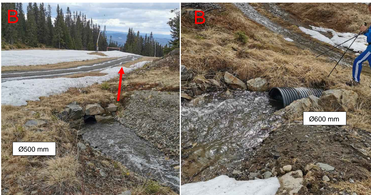
Figur 84: Innløp av stikkrenner i B. De var ved befaringstidspunktet nesten fulle. mhp. kapasitet.
