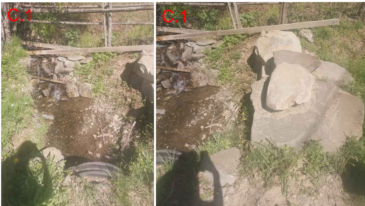
Figur 160: Innløpet til stikkrenna (600 mm) som tar Solbergbekken gjennom en traktorvei ca. 40 m oppstrøms Fjellstadvegen. Dersom stikkrenna skulle gå full eller tettes vil vann ta på avveie sørover, og enten renne over Fjellstadvegen mot bebyggelse eller via Fjellstadvegen og ut i Stubberudbekken. Bildet til høyre viser at det er tydelige erosjonsspor på sørsiden av innløpet, hvor det er bygd en provisorisk erosjonssikring/flomvoll.
