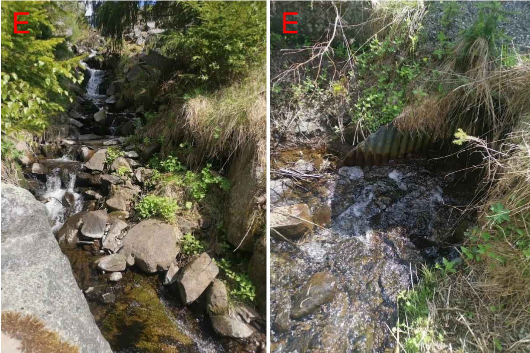
Figur 187: Strekket like oppstrøms og stikkrenna (1000 mm) i punkt E. Det ser ut til at strekket like oppstrøms stikkrenna har en del erosjon, samt at stikkrenna har redusert kapasitet på grunn av sedimenter både ved innløpet og et stykke inn i stikkrenna. Antakelig skal det en del til før vann går på avveie her, men det er en sårbar stikkrenne som bør etterses og renskes.
