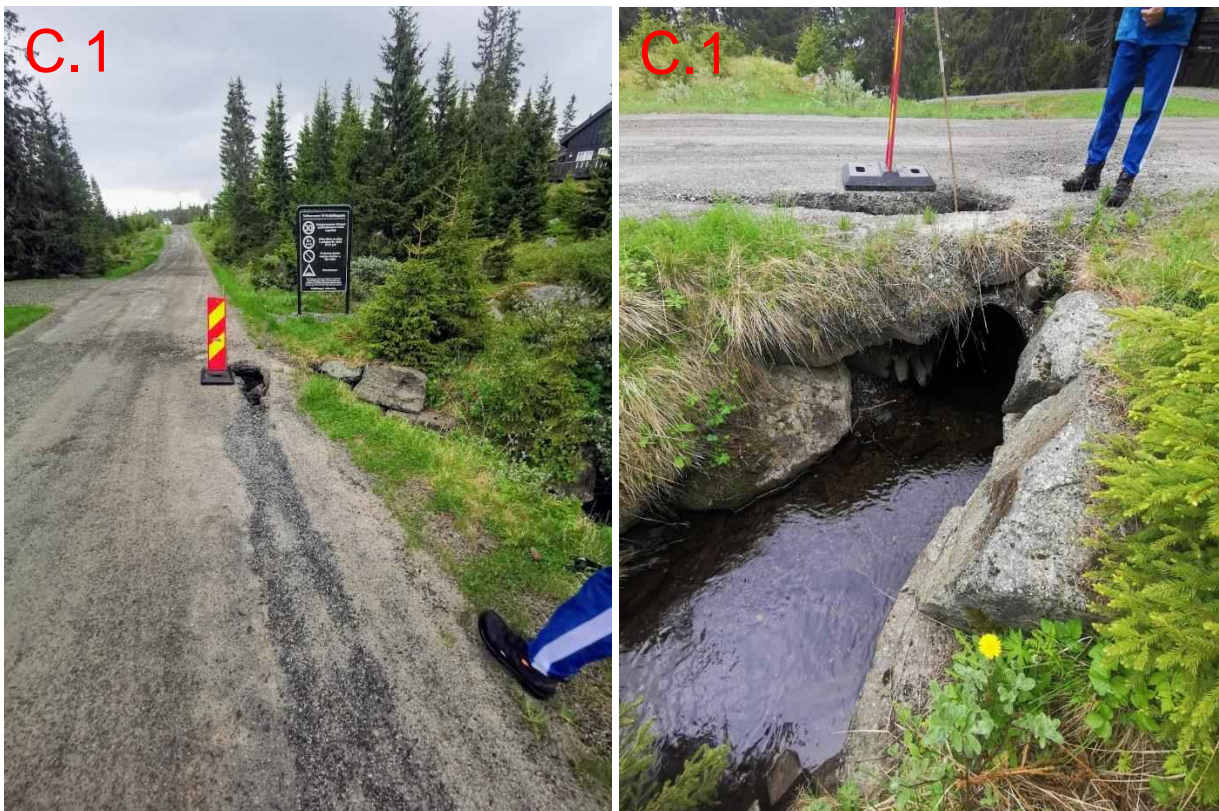
Figur 214: Stikkrenne (800 mm) gjennom Vardvegen hvor veien ved innløpet er delvis erodert bort. På dette punktet er det også erodert i sidene på utløpet.
