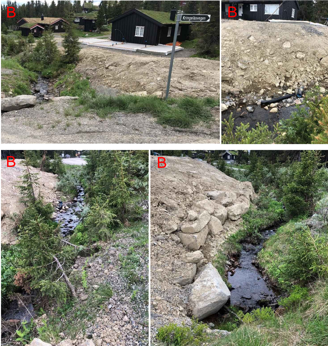
Figur 183: Ved krysset mellom Vardvegen og Kringelåsvegen er det laget en fylling helt ut i bekken. I tillegg er det lagt drenerør fra hytta og rett ut i bekken. Kantvegetasjonen er ødelagt, bekken er innsnevret og det er stor fare for erosjon og massetransport til nedstrøms områder i en flomsituasjon. Bekkeløp og stikkrenner nedstrøms blir da ekstra sårbare.
