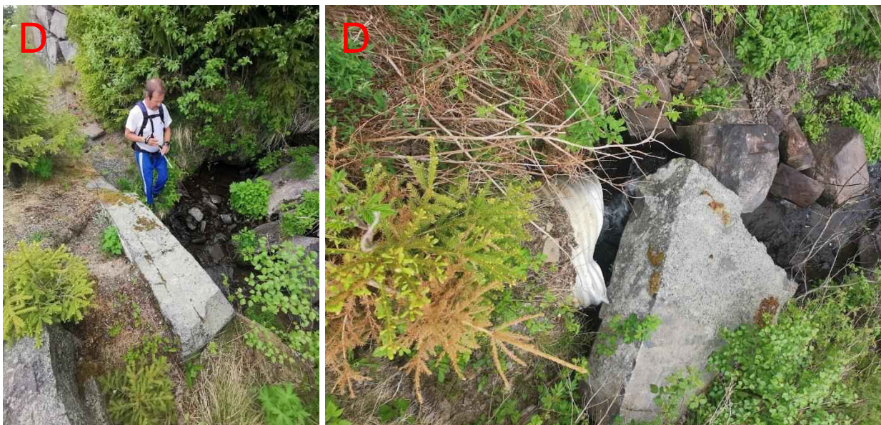
Figur 186: Inn- og utløpet til stikkrenna (800 mm) i punkt D. Dette er en veldig sårbar stikkrenne. Det er mye erosjon og sedimenter ved innløpet. Ved utløpet er det to store steiner som blokkerer utløpet og sannsynligvis blir de tatt med videre med bekken i neste flom. Det er fare for at veien vaskes ut i dette punktet dersom stikkrenna går full eller tettes. Bekken tar sannsynligvis ikke på avveie her, men vil vaske med seg masser.
