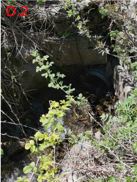
Figur 136: Bildet viser innløpet til den andre stikkrenna (400 mm) ved Larshågån, rett nedstrøms D1, som fører Gunnerheimbekken gjennom adkomstvegen til landbruksbebyggelsen på eiendommen. I dette punktet antas det at vann kan ta på avveie sørover langs adkomstveien og mot bebyggelse dersom stikkrenna går full eller tettes.
