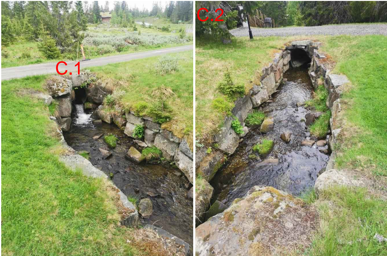
Figur 215: Punkt C, hvor bekken først tas via en stikkrenne (800 mm, C.1) gjennom Vardvegen, kanaliseres, og deretter tas via en stikkrenne (800 mm, C.2) igjennom en adkomstveg til fritidsbebyggelse. I punkt C.2 er stikkrenna klemt litt sammen, og det er erodert en del ved utløpet. Ved utløpet er det i tillegg en del store steinblokker som står i fare for å bli ført med bekken videre i en flomsituasjon. Dette er et sårbart punkt, men vannet vil antakeligvis ta veien tilbake i bekken. Venstre bilde viser utløpet av C1. I det høyre ses innløpet av C2 fra utløpet av C1.
