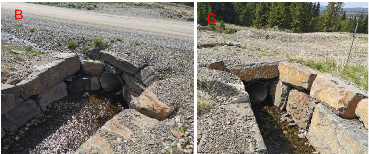
Figur 47: T.v. punkt B. T.h. punkt C. Begge innløpene har flomveier mot høyre langs vegene, og dette har allerede medført en del erosjon.
