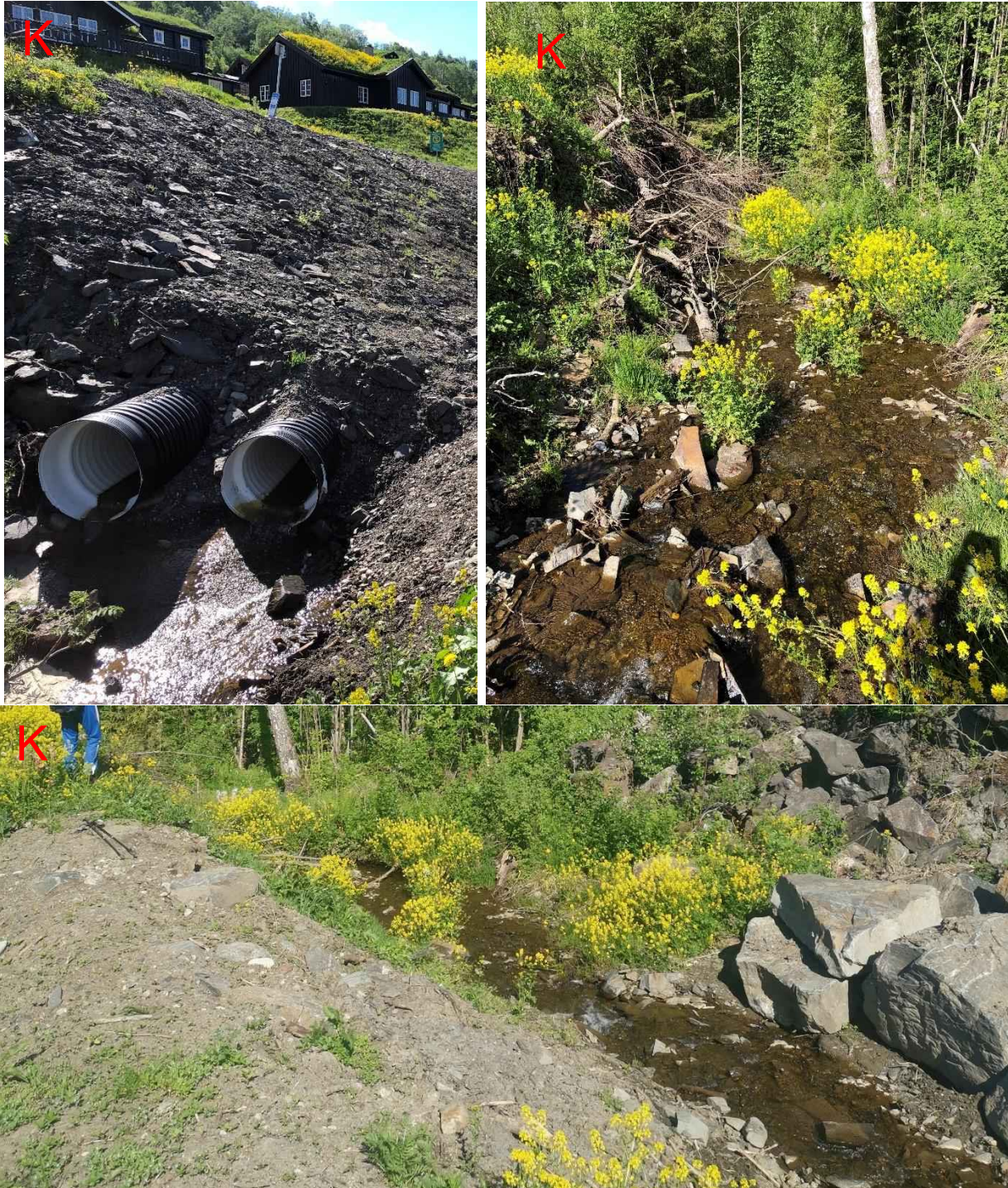
Figur 148: Punkt K. Øverst til venstre er utløpet på de to 600 mm stikkrennene. Utløpskonstruksjonen er dårlig sikret, som bla. fører til fare for utvasking fyllmasser i flomsituasjoner. Det ligger mye stein i bekkeløpet som antakelig blir ført med bekken videre i en flomsituasjon. Øverst til høyre vises bekkeløpet like nedstrøms punkt K, hvor det er lagt hogstavfall i bekken. Bildet nederst viser at det også er lagt fyllmasser helt ut i bekken, med stor fare for erosjon/utvasking og massetransport til nedstrøms område.
