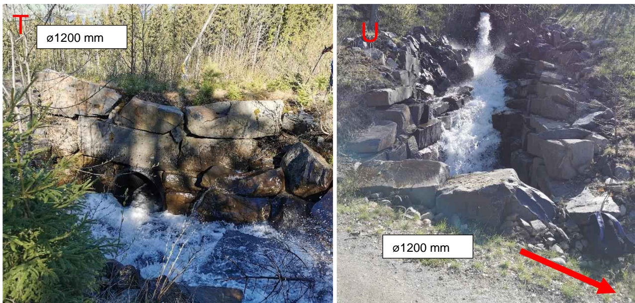
Figur 106: Innløp av stikkrenne i punkt T (t.v.) og nedløp mot stikkrenne i punkt U (t.h.). Fra punkt U går flomveien sørover langs veien. Det ligger en gjentettet stikkrenne som kunne fungert som flomvei, se Figur 107.
