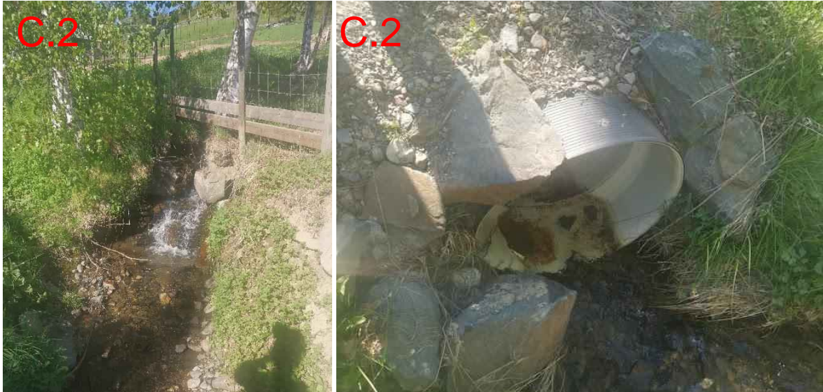
Figur 161: Bildet til venstre viser bekkefaret like oppstrøms stikkrenna (600 mm) i punkt C.2 som fører Solbergbekken gjennom Fjellstadvegen. Bildet er tatt fra Fjellstadvegen. Bildet til høyre viser innløpet til stikkrenna. Masser lenger oppstrøms i bekken gir et potensiale for at stikkrenna gjennom Fjellstadvegen kan tettes og gå full. Dersom stikkrenna tettes eller går full viser Scalgo at vannet vil følge Fjellstadvegen og til slutt havne i Stubberudbekken, som føres gjennom Fjellstadvegen gjennom en stikkrenne som sannsynligvis ikke vil tåle denne ekstra belastningen i en flomsituasjon. En visuell vurdering tilsier at vannet også kan ta på vei over jorden nedstrøms og mot boliger langs Sørbygdsvegen, siden grøften til Fjellstadvegen ser noe liten ut.
