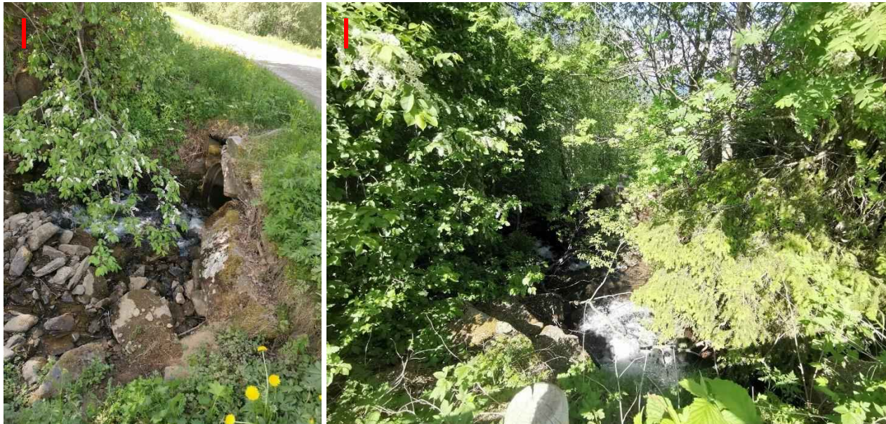
Figur 226: Inn- og utløp til stikkrenne (1000 mm) gjennom Fjellstadvegen. Det er mye erosjon og sedimenter rundt innløpet. Dersom stikkrenna går full eller tettes kan vannet ta på avveie langs grøfta til Fjellstadvegen og videre igjennom en stikkrennene og ende opp i bekken igjen. Men hvor mye tilleggsbelastning denne stikkrenna nedstrøms tåler i en flomsituasjon er usikkert. Da kan vann eventuelt ta på avveie videre igjen over vegen og mot bebyggelsen på Liom.
