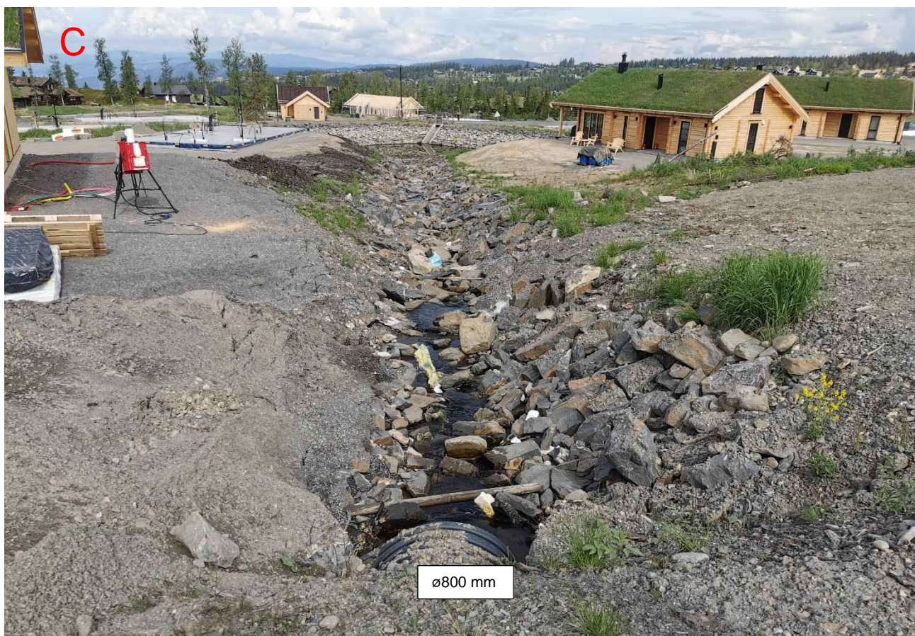
Figur 39: Sett ned mot FLS4 (Strekning C). Det er fylt opp mye løsmasser for tomter og bygget nært inntil bekken, slik at bekken får mindre plass. Dette medfører økt erosjon, massetransport og raskere oppfylling av bassenget nedstrøms, samt at det utgjør en fare for bygningene. Det er også forurensning av vassdraget som følge av byggeaktivitet.
