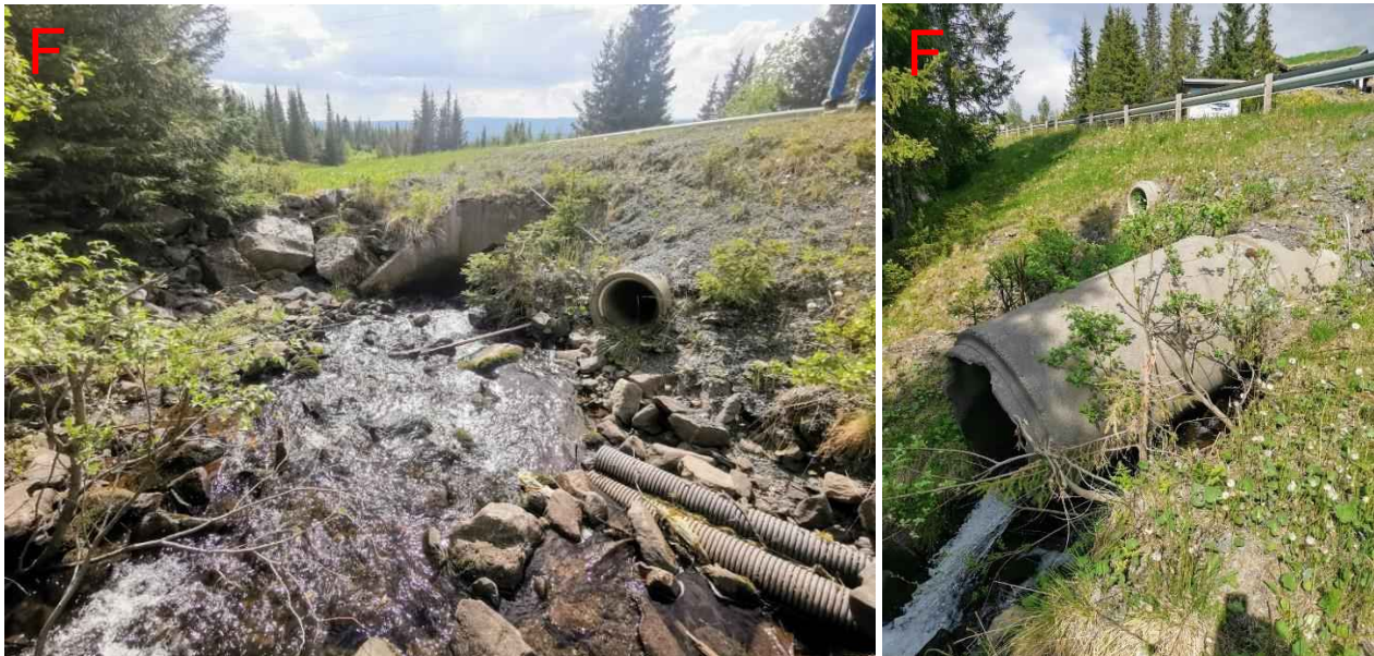
Figur 220: Bildet til venstre viser innløpet til stikkrenna (1000 mm) med vingemur, samt innløpet til flomoverløpet (400 mm), som fører Bjørgebekken gjennom Hundersætervegen ved ca. 760 moh. Innløpet er sårbart, da det er mye løsmasser, søppel og hogstavfall oppstrøms som kan tette stikkrenna, samt at bekken er kanalisert oppstrøms i bekkeløpet som gjør at vannet får stor fart. Oppstrøms stikkrenna ble det også registrert mange taknedløp/drensrør som er lagt helt ut i bekken. Dersom stikkrenna går full eller tettes vil vannet sannsynligvis ta på avveie over i Skalmstadbekken. Ved utløpet av stikkrenna, vist i bildet til høyre, er et skjøt av stikkrenna løsnet, og vil sannsynligvis rase ut i neste flom. Det burde vært gjort en opprydning både ved inn- og utløpet, samt rehabilitering av stikkrenna.
