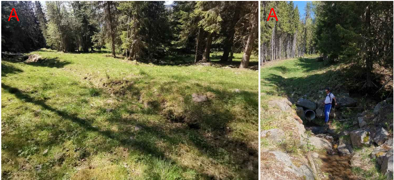
Figur 129: Området i punkt A er en lengre stikkrenne/bekkelukking på et strekke hvor det er tegn til at vann har rent i et profil på overflaten av bekkelukkingen. Bildet til venstre viser strekket ved punkt A som har erodert på oversiden av bekkelukkingen/stikkrenna (500 mm). Bildet til høyre viser utløpet til punkt A. Her vises det i Scalgo at vannet tar veien inn i Gunnerheimbekken igjen dersom stikkrenna går full eller tettes, men fra observasjoner på befaring antas det at det også er mulig at vann kan ta ukontrollert på avveie ut av grøfteprofilen som har blitt skapt på oversiden av stikkrenna, og videre over på jordet nedstrøms.
