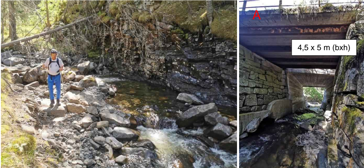
Figur 255: Oppstrøms og innløp av brua under Hundervegen. Det er mye løsmasser i bekkeløpet og stort potensiale for massetransport.
