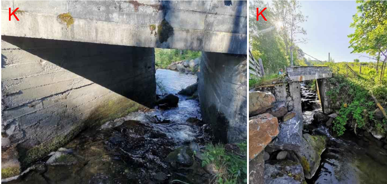
Figur 251: Bildene viser inn- og utløpet til steinbroen i punkt K. Dette er et sårbart punkt hvor vann kan ta på avveie. Innløp med vingemur på én side, ca. 2 m bred og ca. 1.40 m høy "etter" vingen. 3 m bred "utenfor" vingen. Ved utløp er den ca. 2 m høy og 1.60 m bred. Det ligger en stor stein i utløpet som kan forringe kapasiteten.
