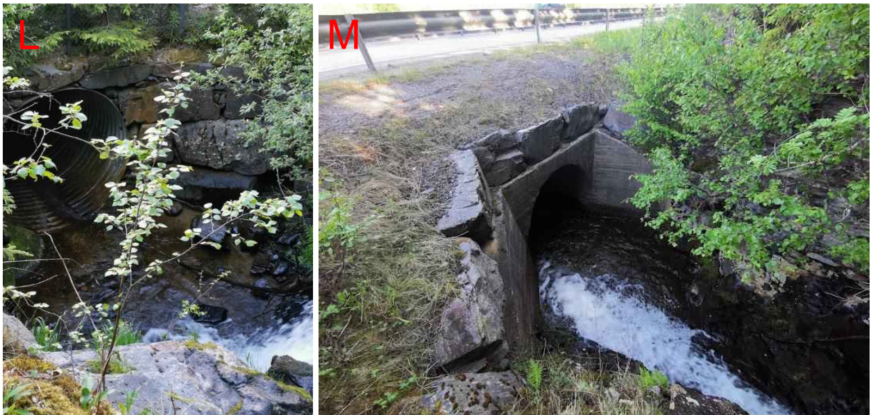
Figur 252: Bildet til venstre viser stikkrenna under Hundervegen (2500 mm), mens bildet til høyre viser stikkrenna under E6 (2500 mm).
