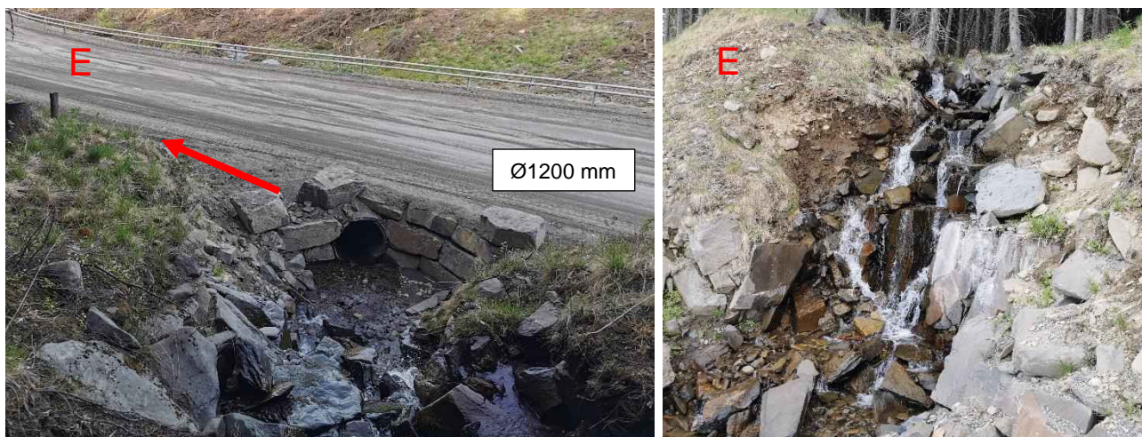
Figur 76: Innløp av stikkrenne i punkt E (t.v.) og nedløpet umiddelbart oppstrøms stikkrenna (t.h.). Nedløpet er bratt, og det er mye erosjon og massetransport. Dette kan medføre større utrasing ved flom som kan tette stikkrenna nedstrøms.
