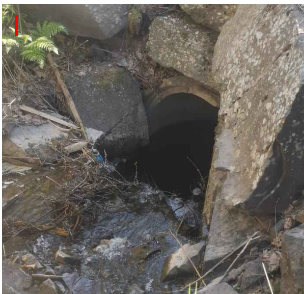
Figur 173: Innløpet til bekkelukkinga (1000 mm) i punkt I. Det er sedimenter ved innløpet som reduserer kapasiteten.
