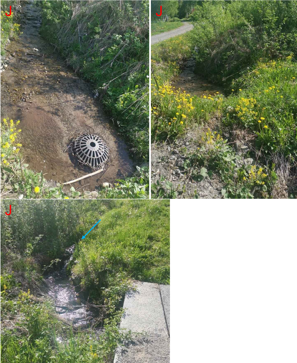
Figur 146: Punkt J. Øverst til venstre er kuppelristen, med ukjent dimensjon videre. Øverst til høyre vises overløpet fra kuppelristen, som fører grunnvannsbekken inn i Gunnerheimbekken ved flom. Det er tydelige spor på at det har drenert vann over her tidligere. Nederst vises hovedbekken som renner ned i veggroften like nedstrøms kuppelristen.
