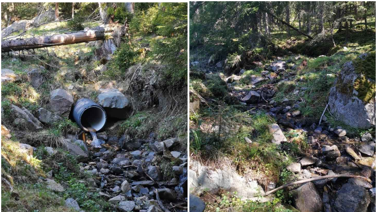
Figur 130: Bildet til venstre viser erosjon på oversiden av stikkrenna (600 mm) like nedstrøms punkt A. Bildet til høyre viser bekkeløpet litt lengre nedstrøms for nevnte stikkrenne, hvor vi kan se at det er mye stein og kvist som kan tas med bekken videre i en flomsituasjon.
