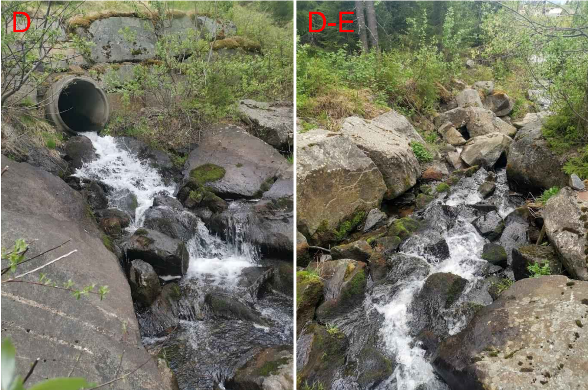
Figur 217: Utløpet av stikkrenne (1000 mm) i punkt D, samt strekket mellom punkt D og punkt E. Det er flere store steiner i bekkeløpet som kan bli dratt med ned mot stikkrenna gjennom Hundesætervegen, som er en sårbar stikkrenne.
