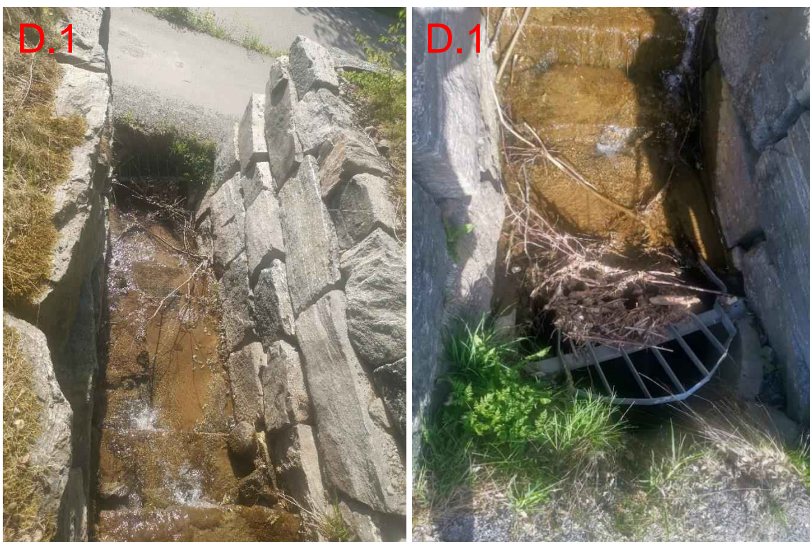
Figur 164: Stikkrenna (600 mm) under Sørbygdsvegen som er i ferd med å gå tett. Strekket ovenfor stikkrenna er veldig sårbart for erosjon som kan fraktes med videre ned til stikkrenna.
