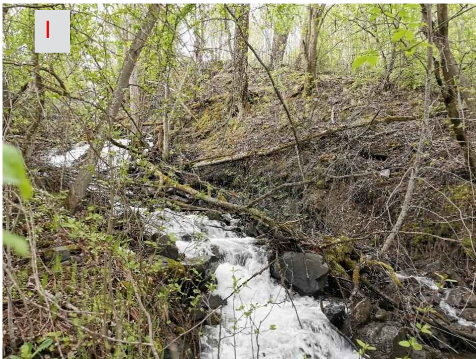
Figur 123: Strekning I - Erosjonsskader langs siden, trær og mye løsmasser i bekkeløpet som kan føre til problem nedstrøms, bl.a. i J.
