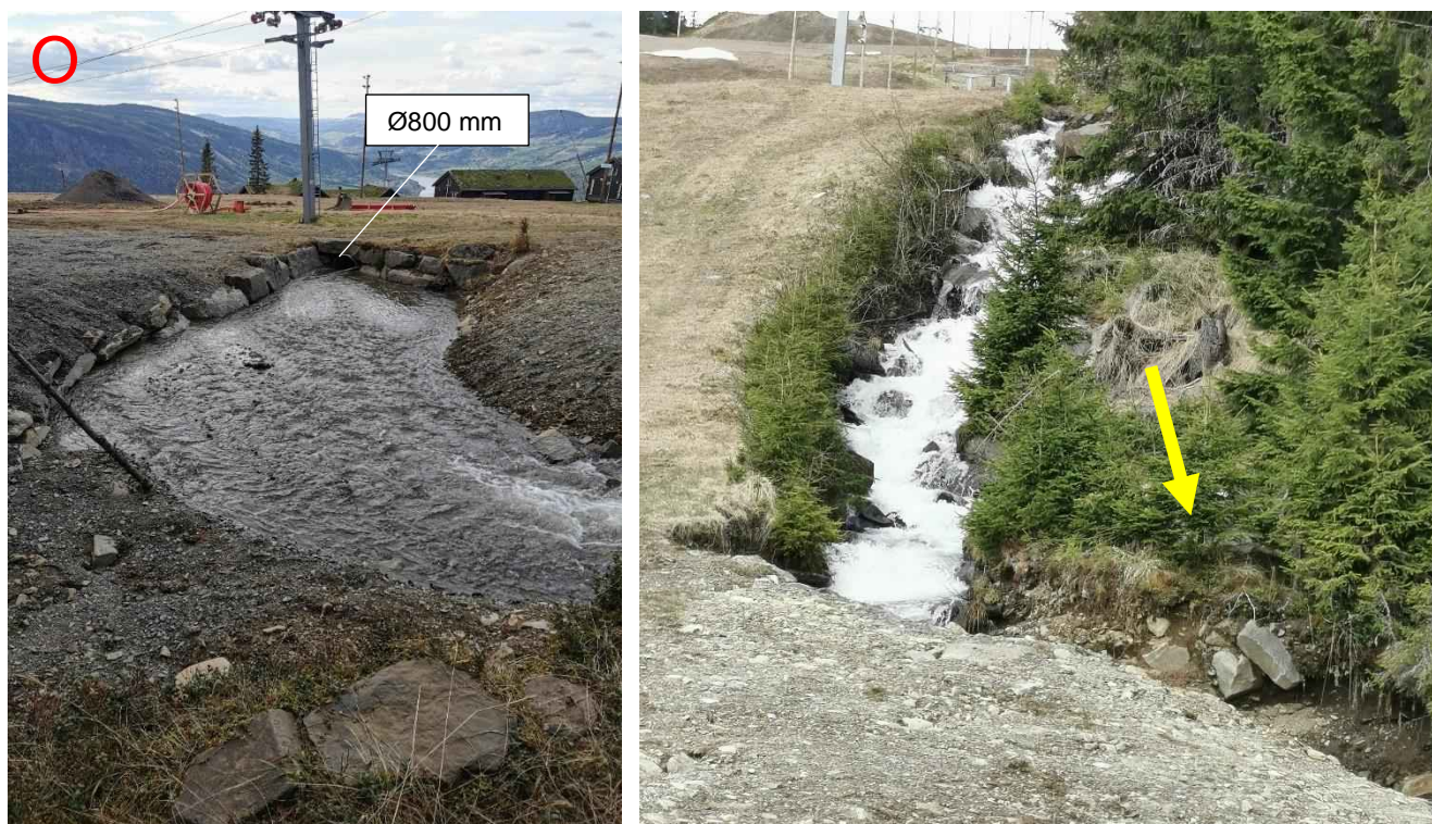
Figur 97: Innløp på den lengre lukkingen i punk O (t.v.). Oppstrøms er det en god del erosjon og massetransport langs bekkeløpet, som vist på bildet til høyre. Det er fare for at dammen i O fort kan fylles opp i en stor flomsituasjon.
