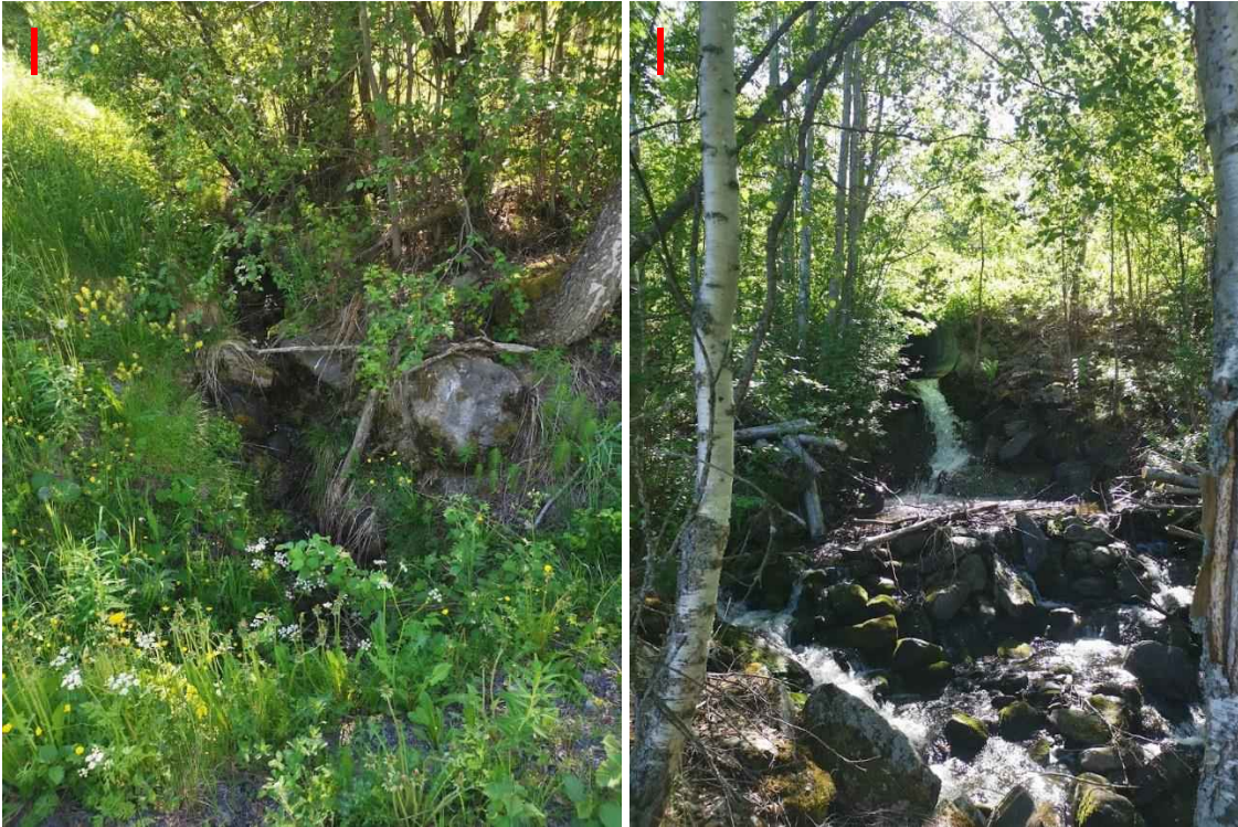
Figur 248: Inn- og utløpet til den 1600 mm stikkrenna som tar bekken igjennom Sørbygdsvegen. Her kan vann ta på avveie sørover dersom stikkrenna tettes eller går full.
