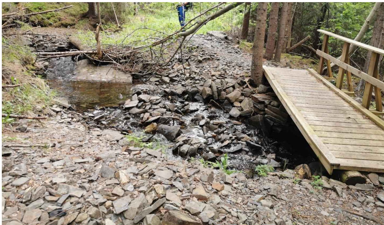
Figur 263: Brua på Tjodvegen/Pilegrimsleden som krysser Kvesa er satt opp relativt nylig etter at flom rev den gamle med seg (trolig i 2014). Resten av gammel bru ligger i bekkeløpet nedstrøms og bør fjernes). Bildet viser også typiske masser i hele bekkeløpet, som tyder på at grunnen består av oppsprukket fjell/forvittringsmateriale.
