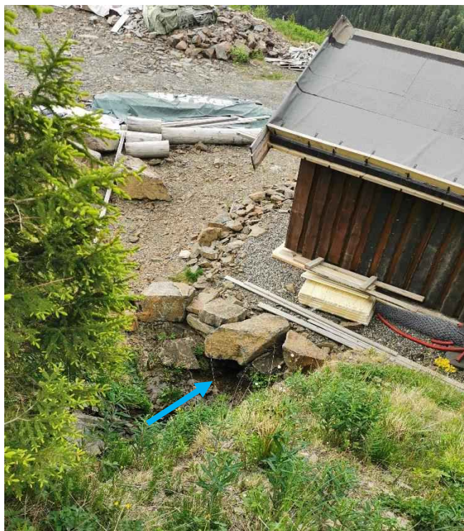
Figur 29: Lukking av vassdrag under skur/anneks ved Lyusveknappen 14. Liten dimensjon på stikkrenne og fare for gjentetting kan gi problemer ved flom.
