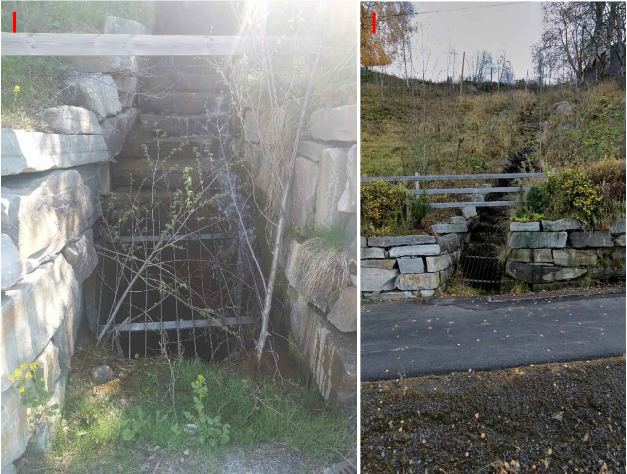
Figur 143: Punkt I på strekket. Bildene viser innløpet til stikkrenna (400 mm) under Sørbygdsvegen. Her vil vannet antakelig renne over Sørbygdsvegen og tilbake i Gunnerheimbekken dersom stikkrenna går full eller tettes. Bildet til venstre er tatt på befarings, mens bildet til høyre er hentet fra Google Street View (tatt oktober 2019).
