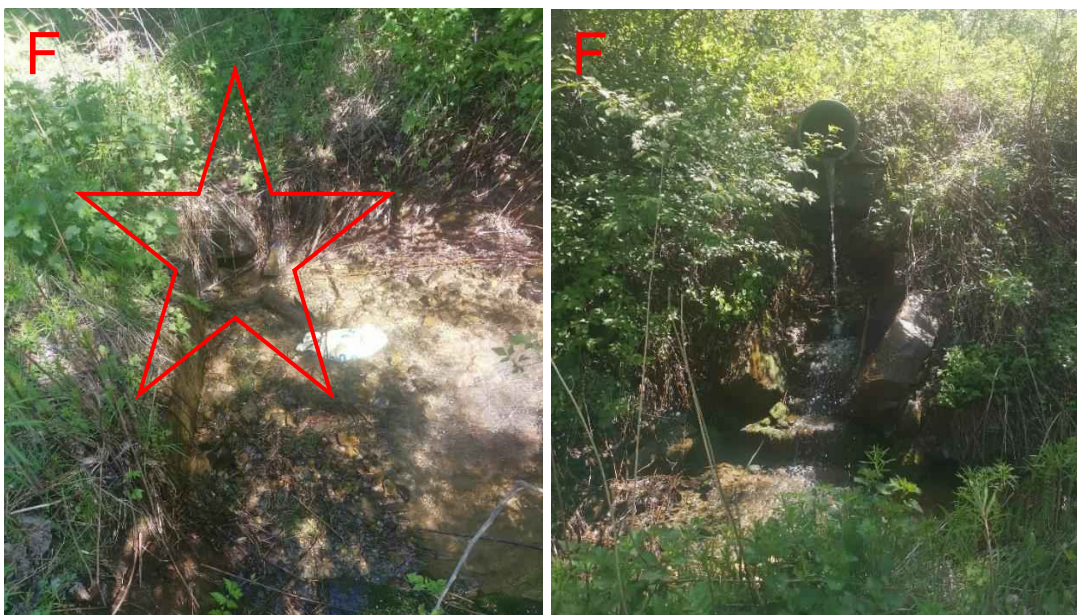
Figur 140: Stikkrenne/bekkelukking (600 mm) i punkt F på strekket. Denne har sterkt redusert kapasitet grunnet sedimenter ved innløpet, og det skal ikke mye til før denne går tett og vann tar på avveie sørover mot Solberg.
