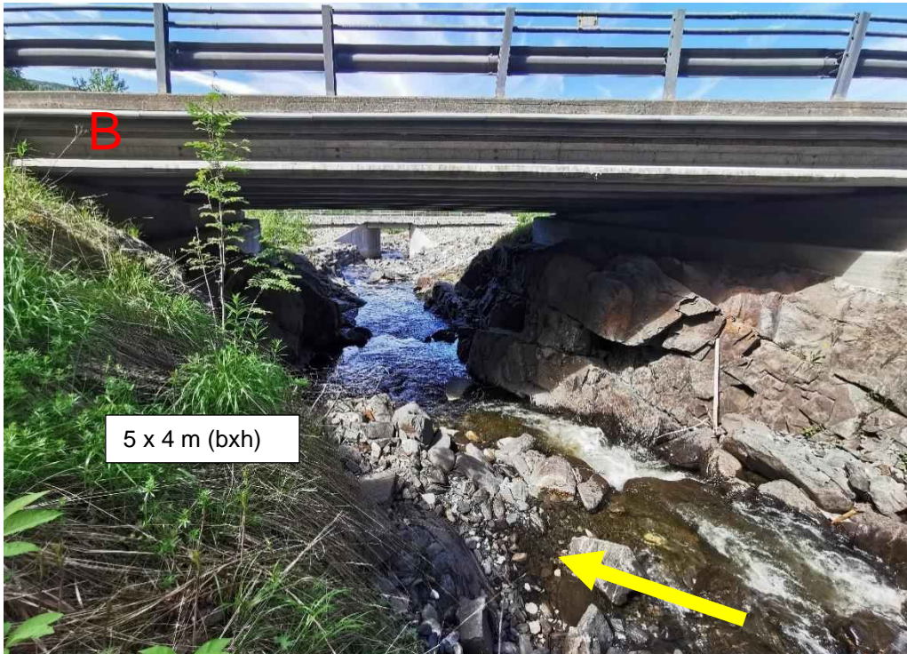
Figur 257: Innløpssiden av brua under E6 (punkt B). Det er en del løsmasser som har samlet seg foran innløpet. Det er sannsynlig at flere steiner vil sedimentere i samme "haug", og på sikt forårsake kapasitetsproblemer dersom massene ikke fjernes jevnlig.
