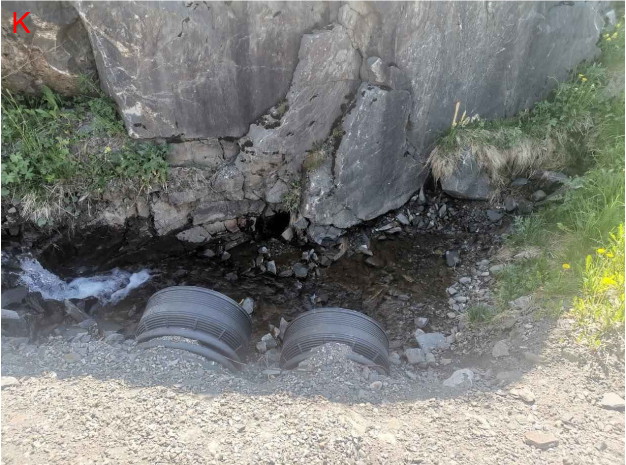
Figur 147: Innløpet til stikkrennene (begge 600 mm) i punkt K. Innløpskonstruksjonen er dårlig, med bl.a. 90 graders innløpsvinkel. Punktet er sårbart mht. utvasking av fyllmasser, bl.a. rundt stikkrennene, i flomsituasjoner.
