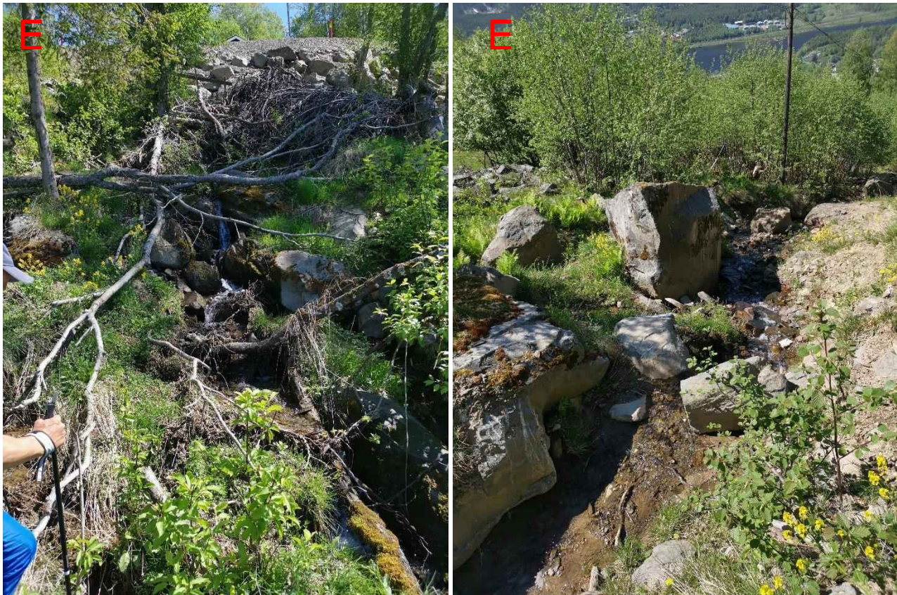
Figur 138: Bildet til venstre viser (sett nedenifra) at det nedstrøms stikkrenna i punkt E er store mengder fyllmasser, og det er lagt hogstavfall svært nærme/i bekkeløpet. Her kan vann ta på avveie ut av bekkeløpet, men det vil antakelig renne tilbake til bekken igjen. Bildet til høyre viser at det har erodert i bekkeløpet (på nordre side) like nedstrøms stikkrenna. Lenger nedstrøms, men før punkt F, kan vannet ta ut av bekkeløpet og renne mot Solberg, som illustrert i Figur 133.
