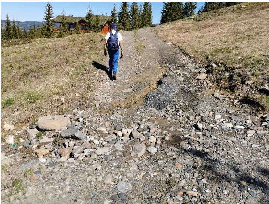
Figur 103: Erosjonsskader over traktorvegen mellom Kaldsvækroken og Tettgrasvegen. Mye vann fra alpinbakken er drenert mot sørsiden av alpinbakken, og i snøsmeltinga kan vannføringen bli relativt stor. Vannet renner videre herfra til flomveien vist i Figur 100.
