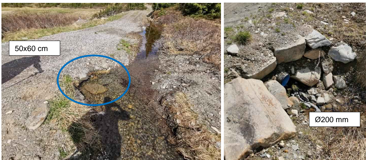
Figur 59: Ved område A er det to stikkrenner, hvorav den ene er en rektangulær stålrinne uten tydelig innløpsutforming (også nesten helt gjentettet (blå sirkel)), og den andre er av plast med delvis erosjonssikring. Dimensjonene er små, og faren for gjentetting er stor. Dette har medført erosjonsskader på veg og grøfter.
