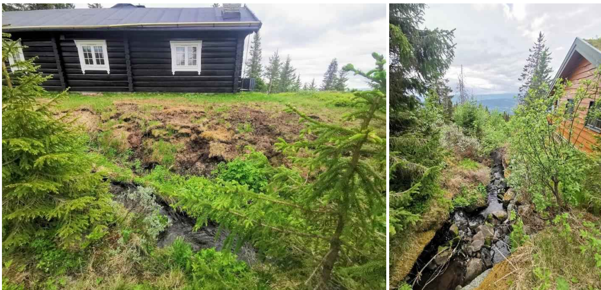
Figur 185: To eksempler på strekket hvor bekken er rettet ut, og det er fylling og bebyggelse veldig nærme bekken. På bildet til venstre er utfylte masser i ferd med å skli ut i bekken og kan bli transportert til nedstrøms områder/stikkrenner.
