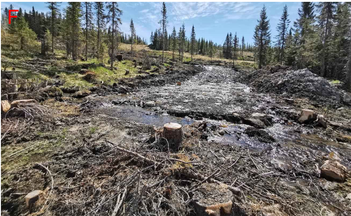
Figur 87: Favntoppen (område F) er et felt som er delvis klargjort for ny bebyggelse. Her møtes også tre vassdrag med betydelig vannføring i flomsituasjoner. Det var ved befaringstidspunktet gjort grovarbeider for en anleggsvei inkludert hugging av trær. Det var ikke tatt hensyn til vassdragene over området, og disse rant dermed diffust over området i stedet for i sine bekkeløp, med konsekvens at det har blitt mye erosjon og massetransport i og ut av området.
