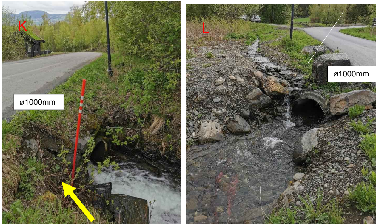
Figur 124: Til venstre: Punkt K, hvor det er tegn på erosjon til siden for stikkrenne, som tyder på at denne har hatt for liten kapasitet tidligere. Til høyre, utløp av stikkrenne i punkt L, hvor kapasitetsproblemer kan medføre vann inn på blant annet campingplassen like ved.
