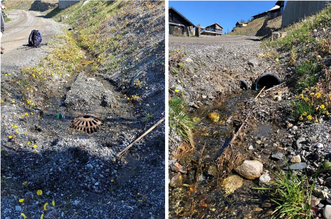
Figur 102: Veggrøfta langs Kaldsvækroken er full av sedimenter og sluket som leder vann til utløp i flomveien (t.v.) på nordsiden av hyttefeltet er nesten gjentettet av grus og stein.
