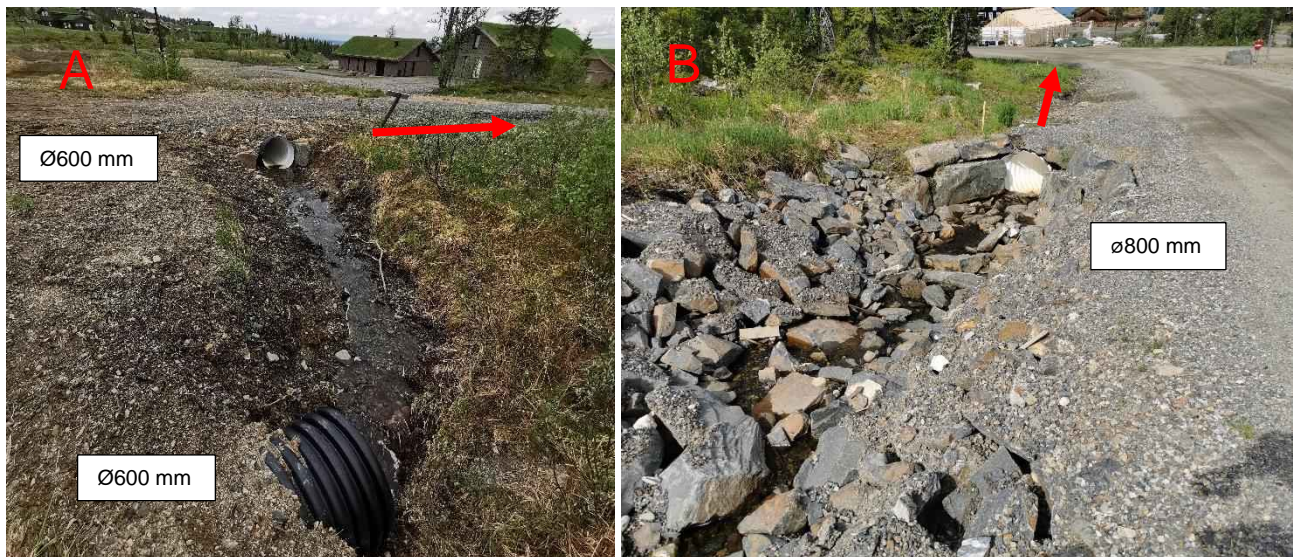
Figur 38: Punkt A (t.v.) og B hvor vann kan ta på avveie mot bygninger ved begrenset kapasitet i stikkrennene.
