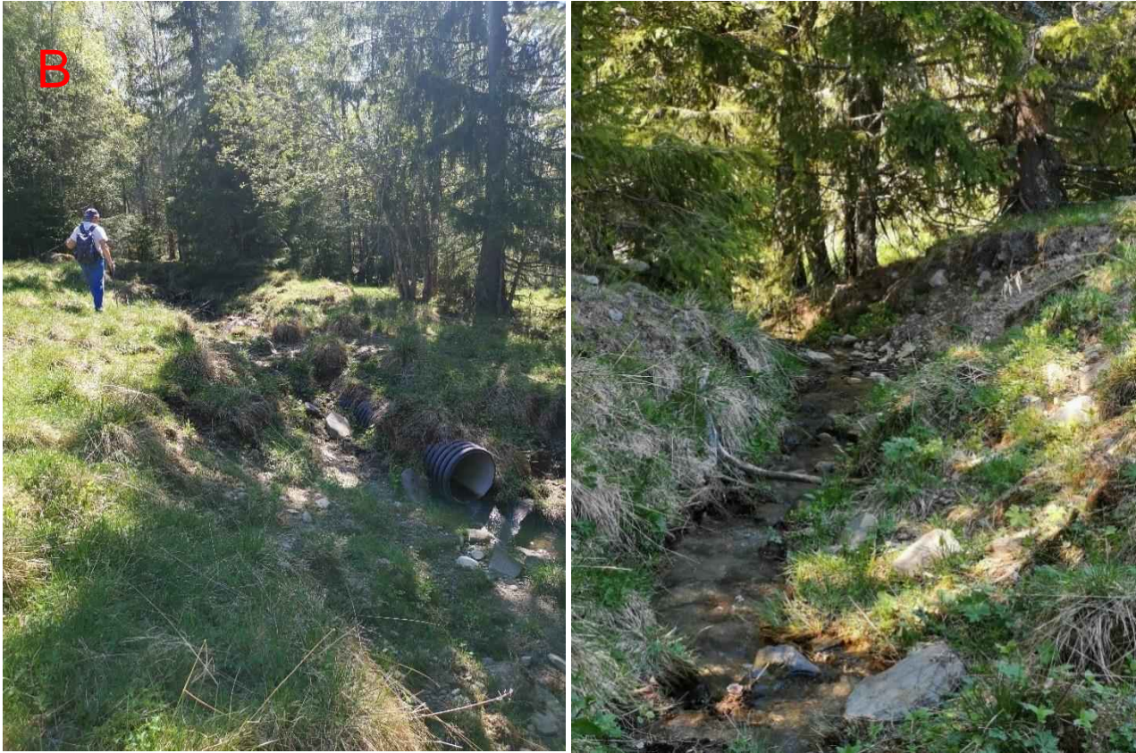
Figur 131: Bildet til venstre viser erosjon på oversiden av utløpet til stikkrenna (500 mm) i punkt B. Her har det erodert så mye at stikkrenna ikke har noen praktisk funksjon. I dette punktet viser Scalgo at vann kan ta på avveie mot Nestingen. Bildet til høyre viser tydelige erosjonsskader i bekkeløpet like nedstrøms punkt B.
