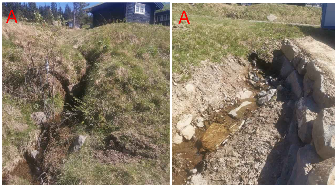
Figur 154: Bildet til venstre viser bekkeløpet oppstrøms stikkrenna (300 mm) i punkt A, sett fra Storsteinvegen. Bekken har liten plass, ettersom det antakelig er fylt ut i sidene på bekken for å muliggjøre mer plass til utbygging. Bildet til høyre viser utløpet til stikkrenna i punkt A gjennom Storsteinvegen. Her er det etablert erosjonssikring på sørsiden av bekken. Fra punkt A og videre nedstrøms er bekken svært preget av utbyggingen av Nestingsætra og VA-trase.
