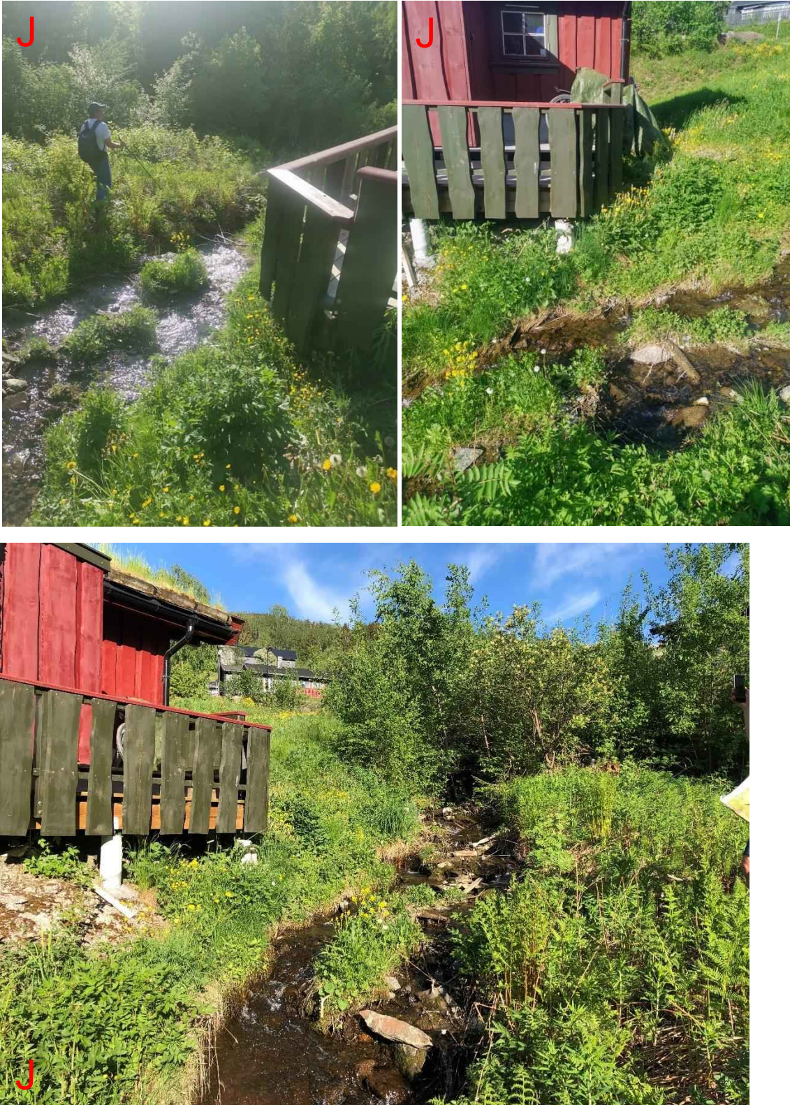
Figur 174: Punkt J, hvor bekken nesten kommer borti fundamentet på fritidsboligen.
