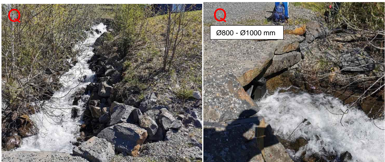
Figur 99: Nedløp mot og innløp av stikkrenne i punkt Q, hvor vann på avveie kan medføre fare for bebyggelse. Erosjonssikringen rundt innløpet er noe usikker, sannsynligvis pga. utvasking av løsmasser rundt større steiner. Dette kan tyde på at innløpet har begrenset kapasitet også ved mindre flommer.
