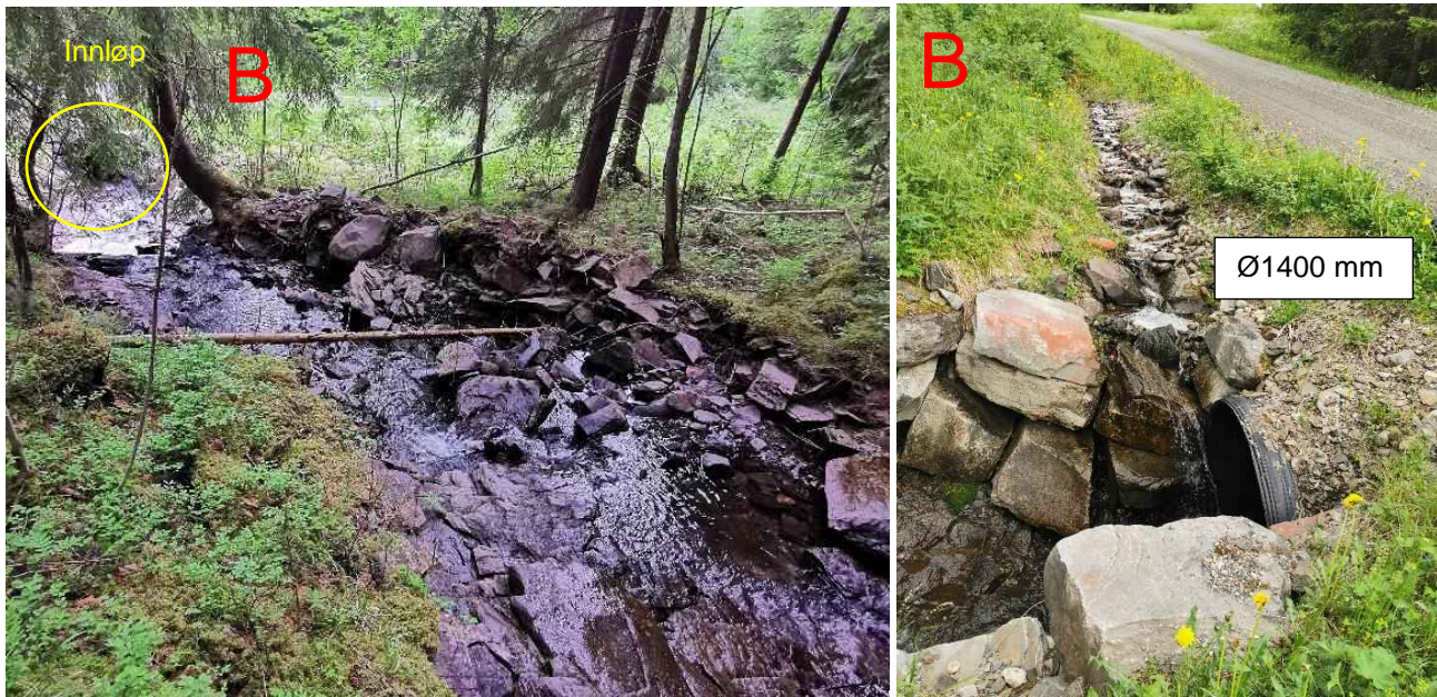
Figur 264: T.v. Oppstrøms innløpet til den nederste av stikkrennene som krysser Tyttebærskogen (punkt B). T.h. ses innløpet til stikkrennen. Potensialet for massetransport er stort i hele bekken og særlig vil massene nærmest innløpene kunne tette igjenn stikkrennene ved neste flom.
